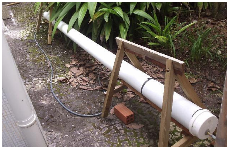
FIGURA 4.5 – UNIDADE DE TRATAMENTO TUBULAR DE ESGOTO
