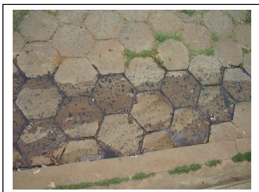
Figura 11: Esgoto em uma rua de Mirabela Autora: FONSECA, G. S, 2008
