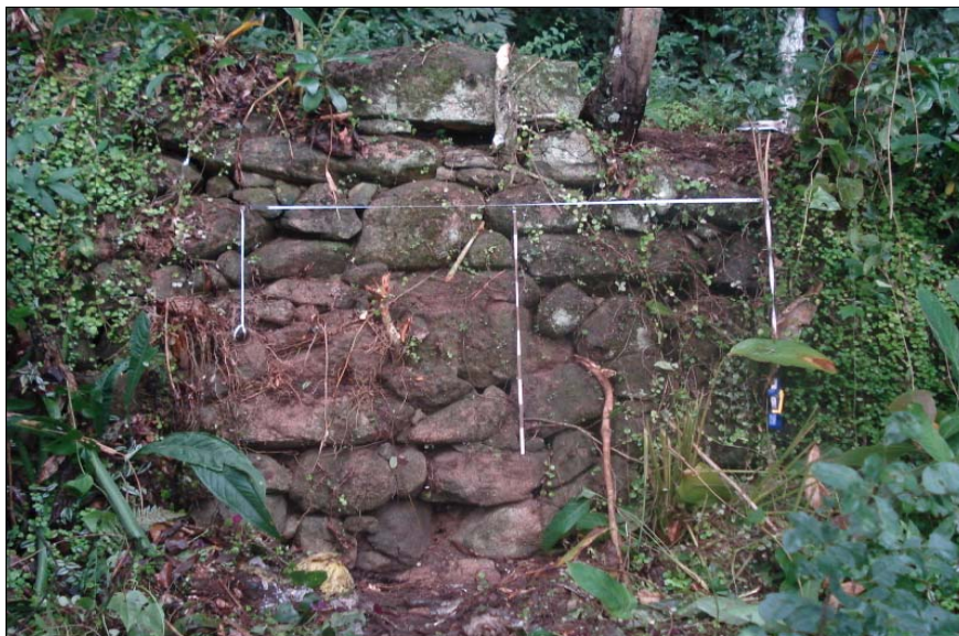
Figura 86 - Detalhe da face 2 da estrutura 1 – A parte inferior tem lixo acumulado
