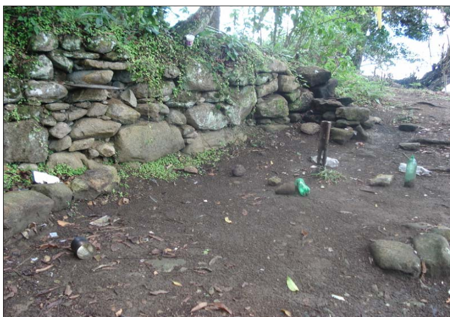
Figura 82 - Descaracterização da estrutura 1
