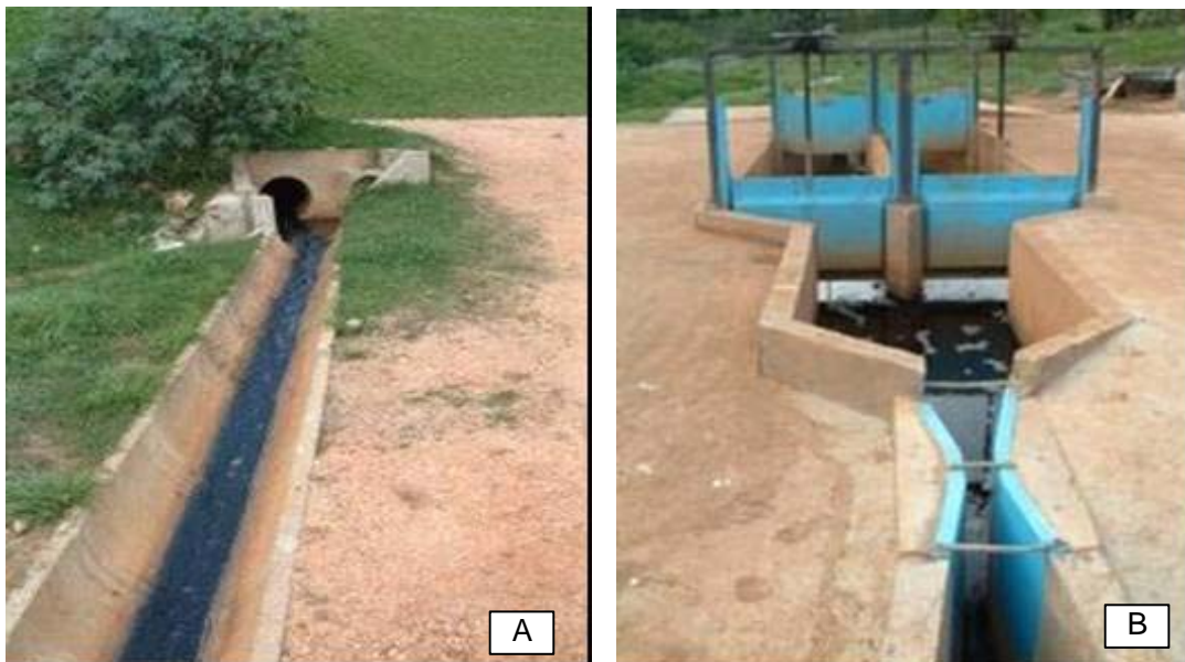
FIGURA 2.1 – SAÍDA DE CHORUME – ATERRO DA CAXIMBA CURITIBA: A) CANALETA COM CHORUME, B) MEDIDOR DE VAZÃO DE CHORUME
