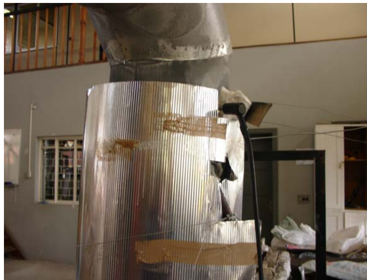
FIGURA 36 - POSIÇÃO DA SONDA DO ANALISADOR DE GASES NA CHAMINÉ DE TIRAGEM INDUZIDA
