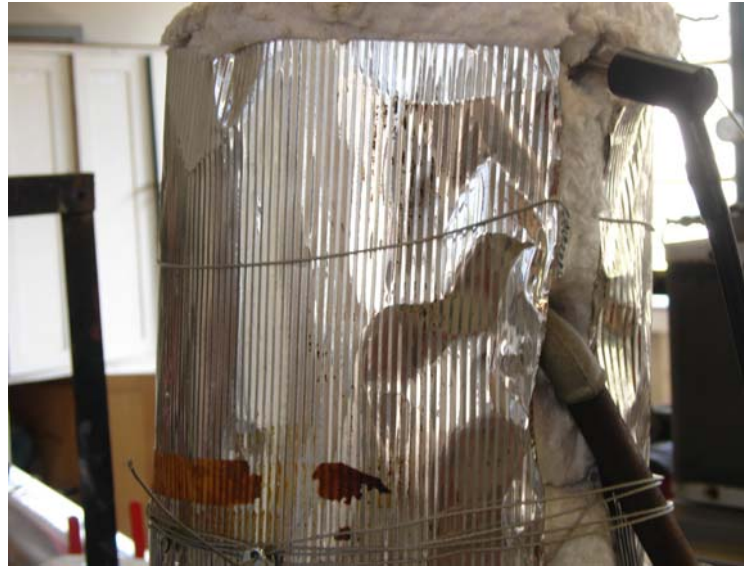
FIGURA 35 – POSIÇÃO DA SONDA DO ANALISADOR DE GASES NA CHAMINÉ DE TIRAGEM NATURAL
