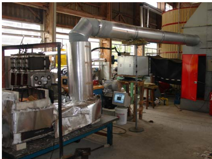
FIGURA 25 – CHAMINÉ DE TIRAGEM INDUZIDA FONTE: O autor (2008)
