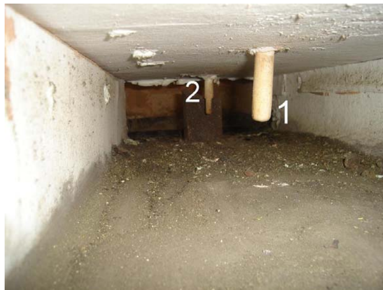
FIGURA 30 – INTERIOR DA CÂMARA DE COMBUSTÃO
