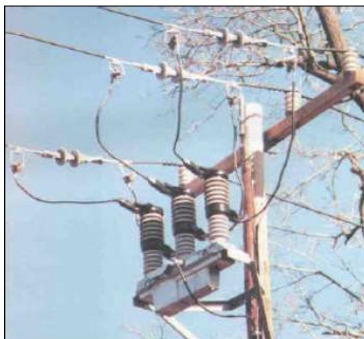
Figura 11 - Seccionador Automático Instalado [14].
