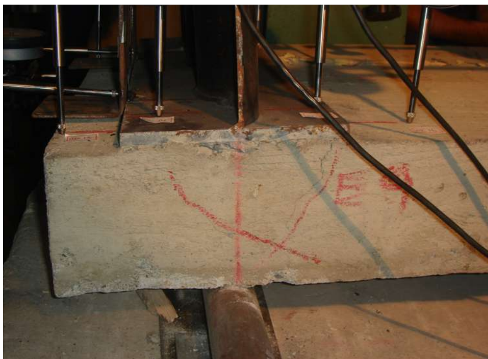
FIGURA 3.25 Fissuras diagonais nas extremidades da laje do protótipo U2-P
