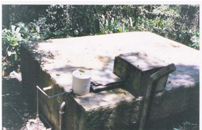
11: Rua das Flores – alto curso do Córrego do Bicão- detalhe para a caixa de passagem de água. Fonte: A autora, 2005.
