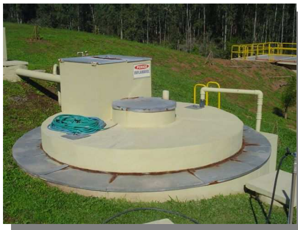
Figura 5: Reator anaeróbio UASB.
