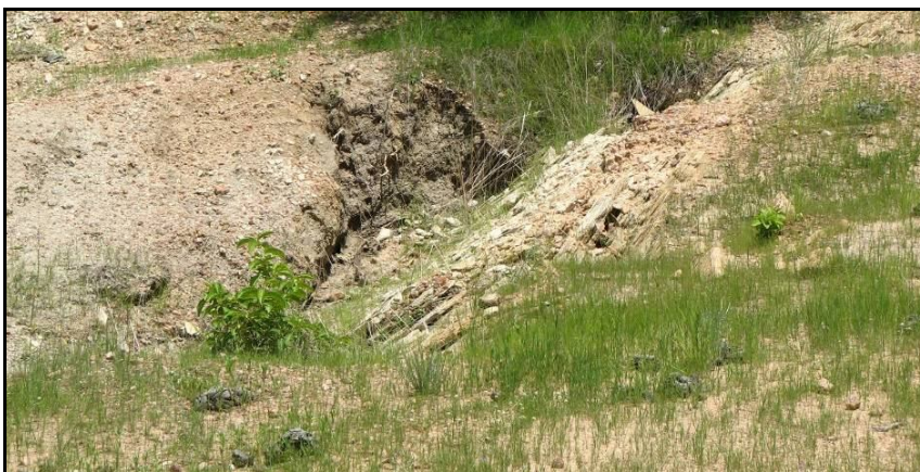
Figura 25 – Erosão em formas de sulcos (março / 2007)
