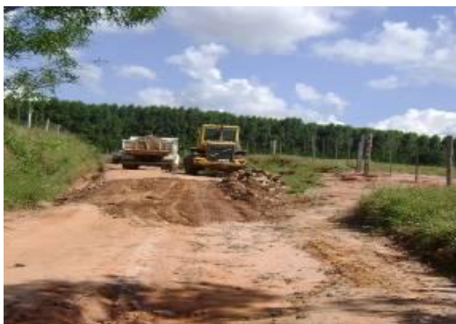
Figura 04 – Caminhões despejando “entulho” em estrada municipal.
