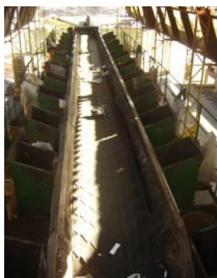
Figura 119 – Esteira de triagem de materiais recicláveis à partir dos RSD.
