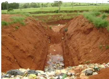
Figura 176 – Vala do aterro de Ubirajara e detalhe dos resíduos.
