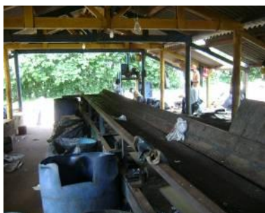
Figura 107 – Esteira de triagem da central de triagem de recicláveis.
