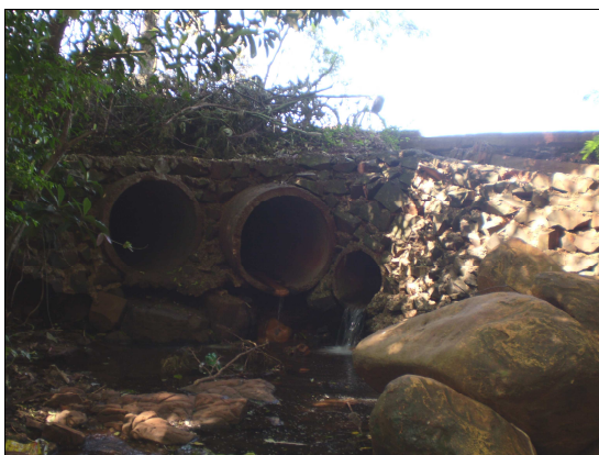
Figura 17 - Detalhe das galerias pluviais no final da Rua Ceará. Acervo Pessoal.
