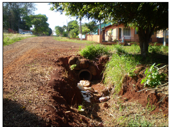
Figura 16 - Feição erosiva nas laterais da Rua Colombo. Acervo Pessoal
