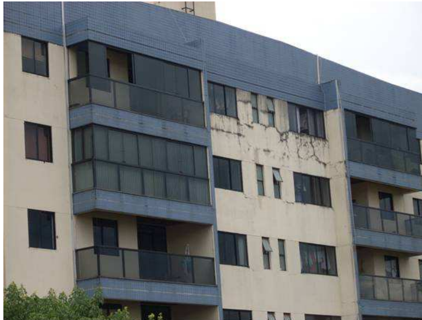
Figura 2.9 – Detalhe de fachada com a pintura apresentando defeitos
