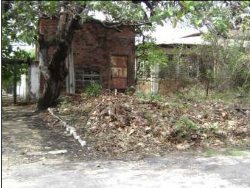
FIGURA 14 – Galpão abandonado no I DIC. Foto: CARVALHO, K. (fev/2009)
