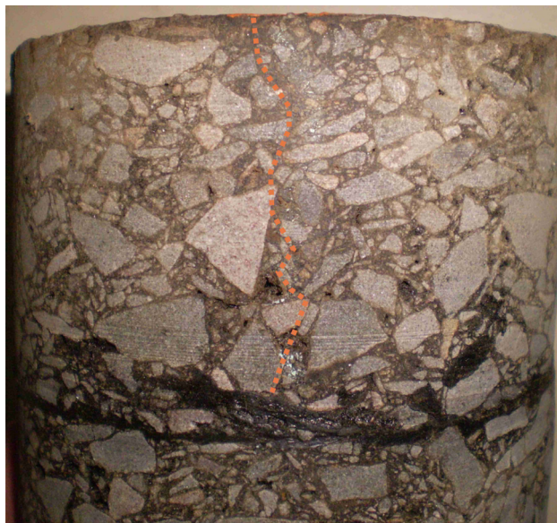
Figura 6.18 – Trincamento iniciando na base do recapeamento
