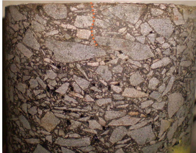
Figura 6.16 – Trincamento do tipo top down cracking
