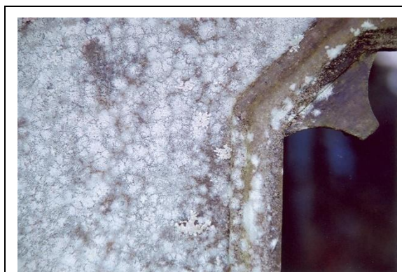
Figura n. 35 – Contaminação Microbiológica: Artefato metálico apresentando líquen aderido à sua superfície.
