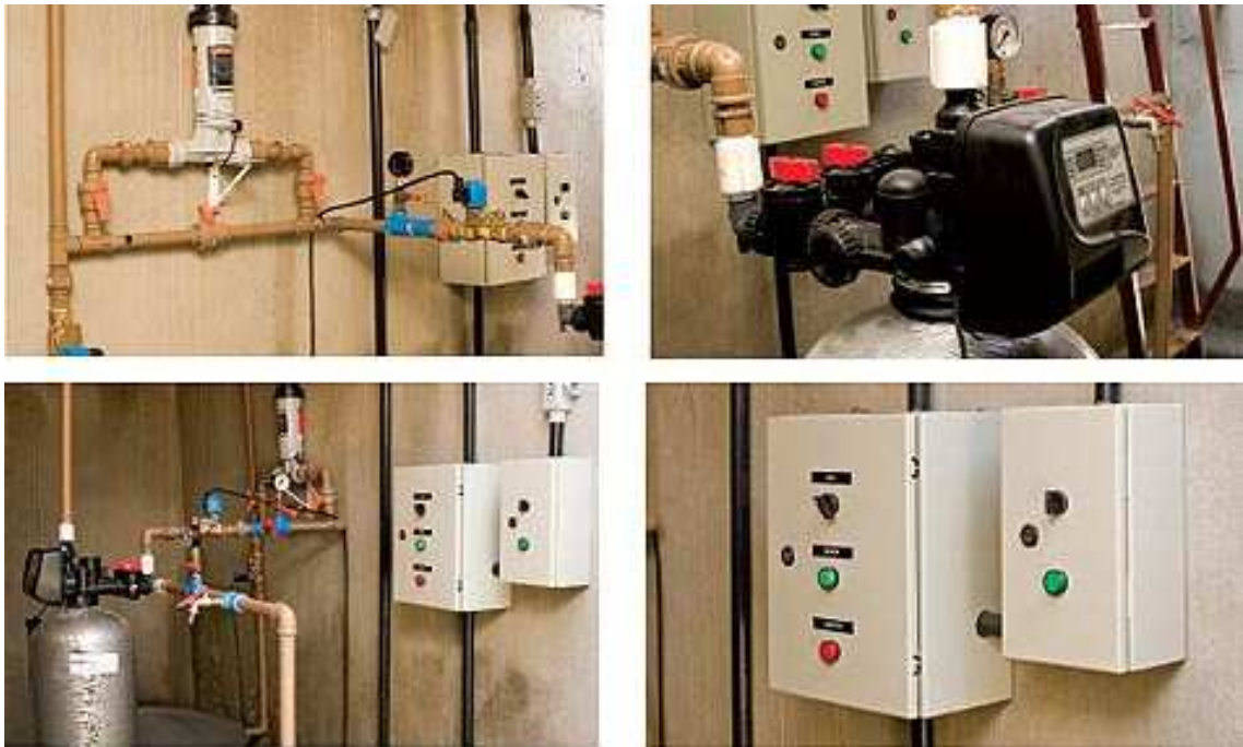
Figura 2.5.h: Componentes da central de tratamento para aproveitamento de água de chuva: Sistema de desinfecção de linha; Válvula automática para filtro; Vista geral dos componentes de automação do sistema; Quadro elétrico de comando.
