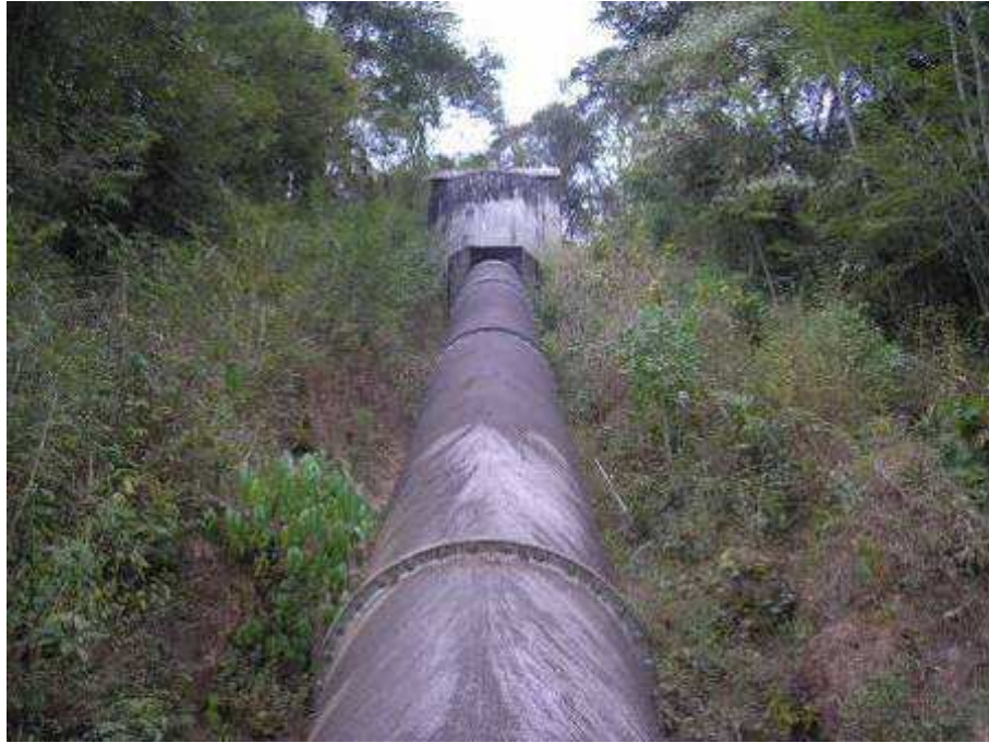
Foto 143 – Conduto forçado da Usina do Salto, onde a altura da coluna d'água é de aproximadamente 70m.
