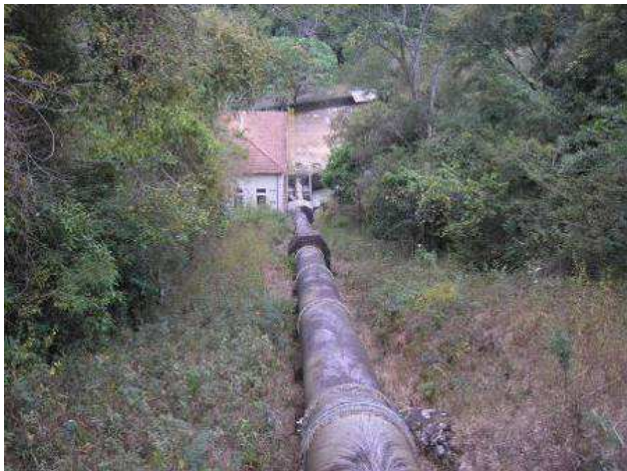
Foto 144 – Tubulação da tomada d'água de grande diâmetro (1,5 m aproximadamente) na Usina Hidrelétrica do Salto.
