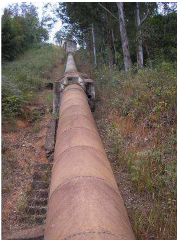
Foto 137 – Conduto forçado da Usina do Caboclo, onde a altura de coluna d'água deve ser de aproximadamente 80 m para o melhor aproveitamento energético.
