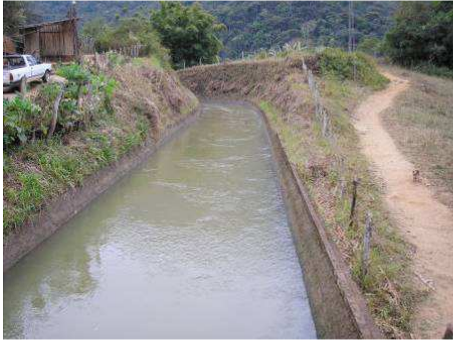
Foto 135 – Vista do canal de condução d'água para a Usina do Caboclo, próximo ao distrito de Santo Antônio do Salto.
