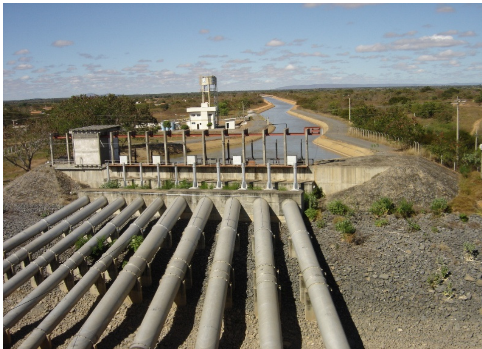
Figura 6 – Em primeiro plano, Estação de Bombeamento (EB) 1, na Etapa I do Projeto Jaíba. Em segundo plano, vista do canal para distribuição de água nas unidades de produção. Fonte: CODEVASF, 2008.
