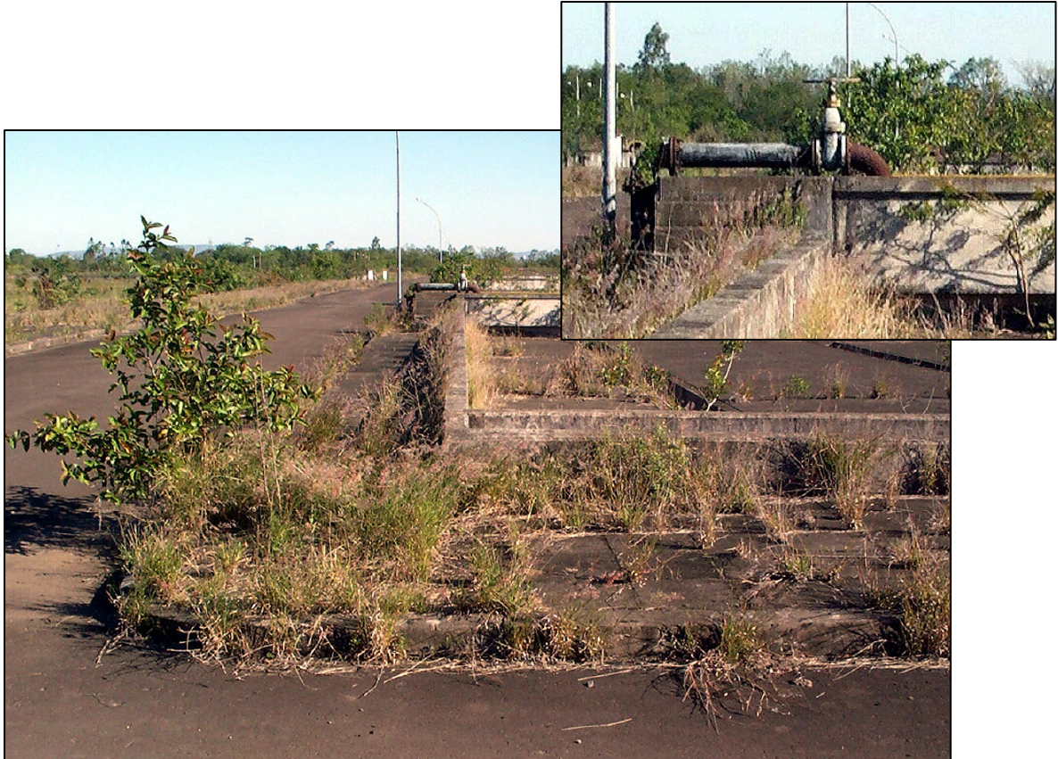
Foto 15: Leitos de secagem do lodo de esgoto. Como a estação de tratamento não tem executado o tratamento de esgotos a pleno, os leitos de secagem do lodo de esgoto, (resíduo do tratamento) permanecem sempre secos. Data: 15/10/2003.
