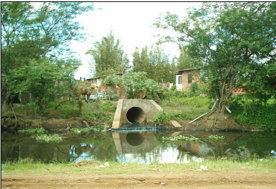
Foto 12: Tubulação localizada nas proximidades da esquina da Rua Ulisses Guimarães com a Av. Irineu C. de Braga, despejando esgotos sanitários diretamente na Vala da Irineu. Data: 21/10/2003.
