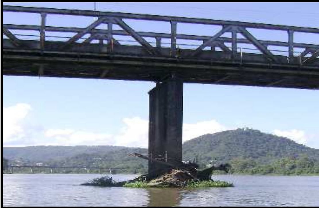
Figura 10 - Entulhos nos pilares da Ponte Machado da Costa, em Porto União – SC (2009)
