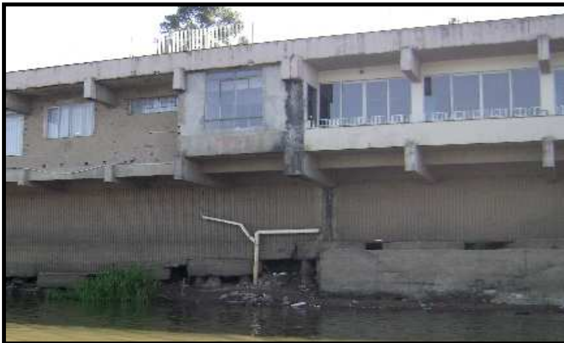
Figura 17- Saída de esgoto no Clube Concórdia, na área urbana de Porto União – SC (2009)
