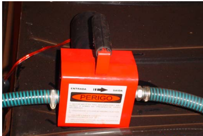
FIGURA 2. Bomba de abastecimento.
