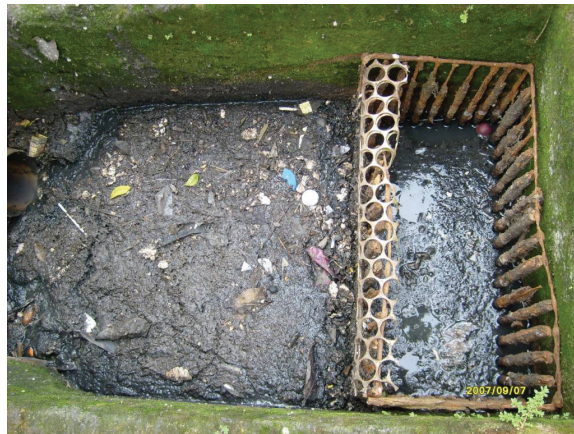
Figura 4.2: Compartimento central da ETE da Comunidade Emaús-Ubatuba/SP, com grades para a remoção de sólidos grosseiros.
