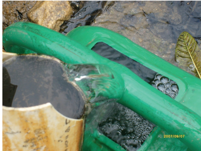
Figura 4.5: Saída do efluente da Comunidade Emaús-Ubatuba/SP, após ter passado pelo sistema de tratamento.
