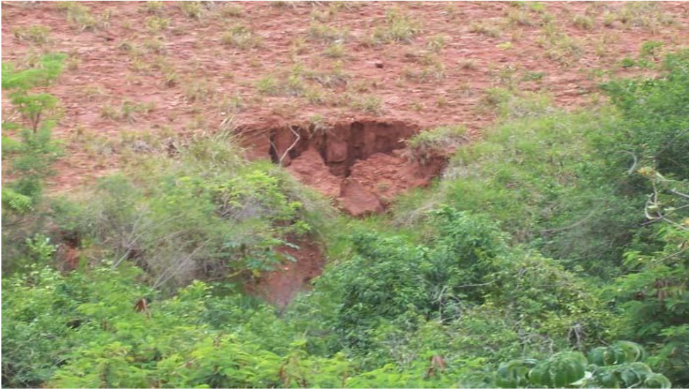
Figura: 36- Taludes sofrendo processo erosivo.
