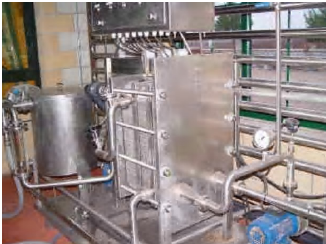
Figura 3 – Pasteurizador equipado com placas com as seções regenerativas.
