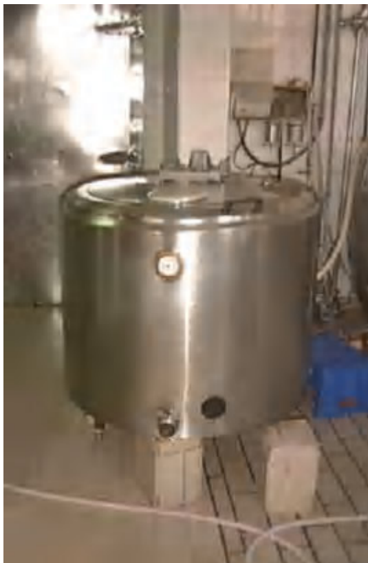
Figura 2 - Tanque de pasteurização lenta.
