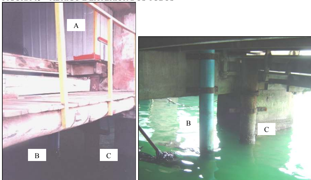
FIGURA 13 – ABRIGO E EXTERIOR DOS TUBOS
