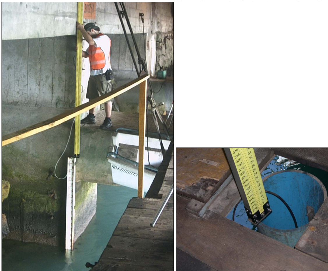
FIGURA 44 – NIVELAMENTO DA RÉGUA MAREGRÁFICA E DO TUBO DO MARÉGRAFO
