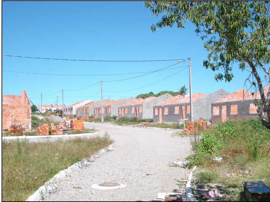
Figura 15 – Casas do Loteamento Cipriano Rocha em fase de construção. Fonte: Registro fotográfico do autor, 2009.
