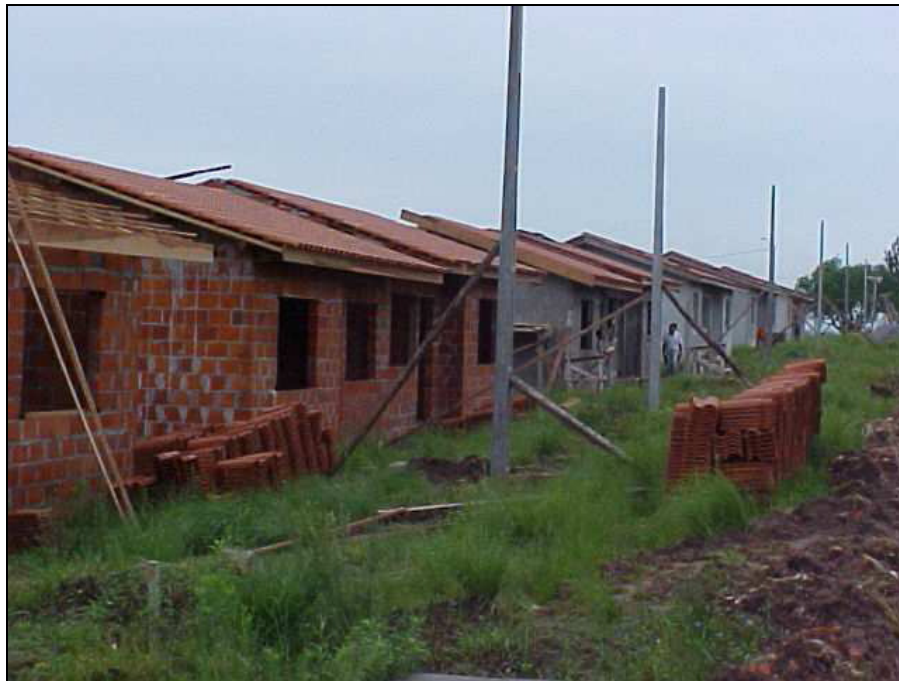
Figura 08 – Casas do Programa Habitar Brasil em fase de construção na cidade de Santa Maria. Fonte: Arquivo SMIHS, 2003
