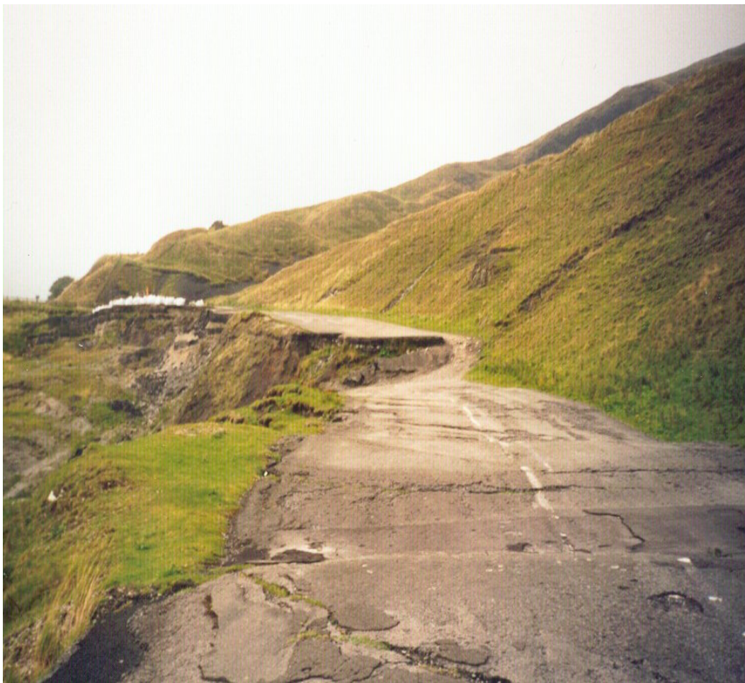
Figura 2.3: Foto da estrada A6187, na Inglaterra, próximo a Castleton. Cisalhamento do solo tornou-a destruída e impossível de se trafegar.
