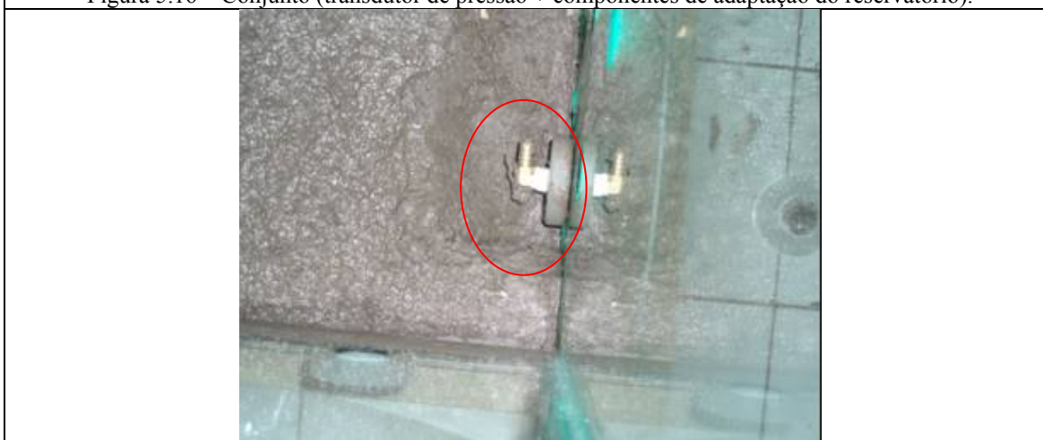
(a) Vista superior do reservatório mostrando o adaptador do transdutor de pressão instalado ao fundo.
