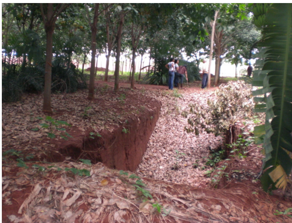
Figura 20: Caixa de contenção para amenizar as erosões causadas por águas pluviais.
