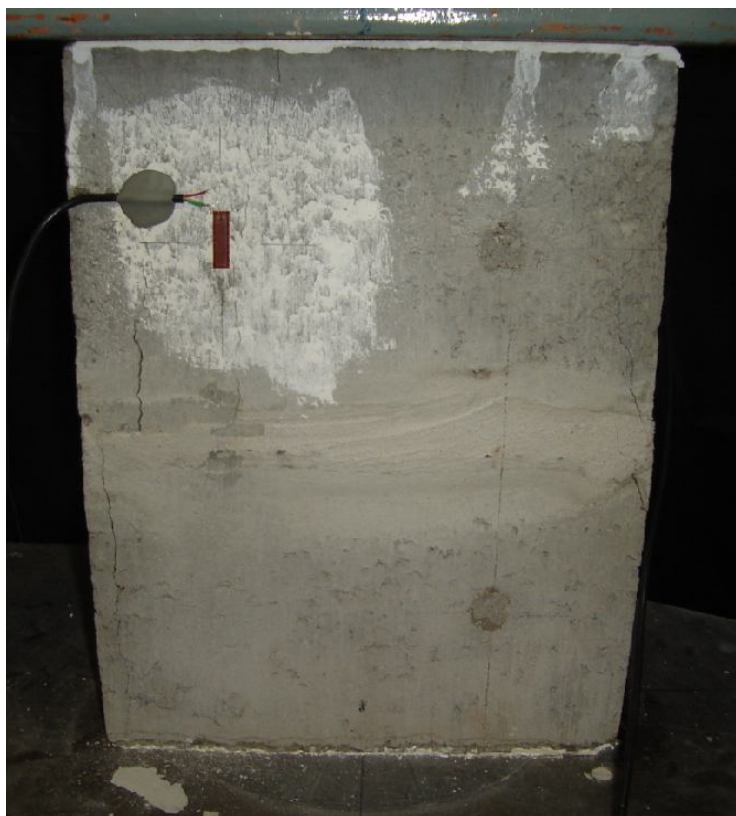
Figura 5.32 - Fissuração nos prismas PR2-A02-G1.
