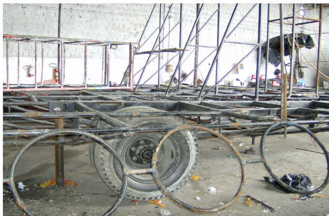
Fig.3 - Ferragem do carro alegórico em construção no barracão da Rosas de Ouro 2006.
