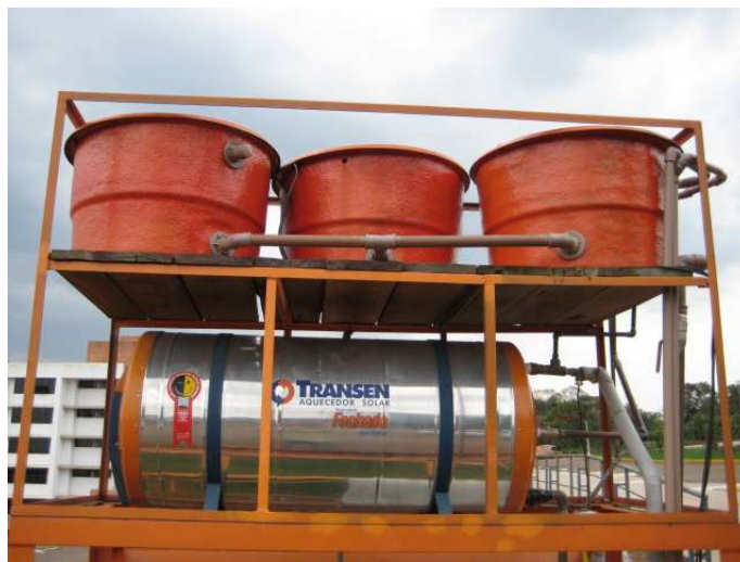
FIGURA 21– Reservatório térmico (abaixo) e reservatório de água fria (acima)
