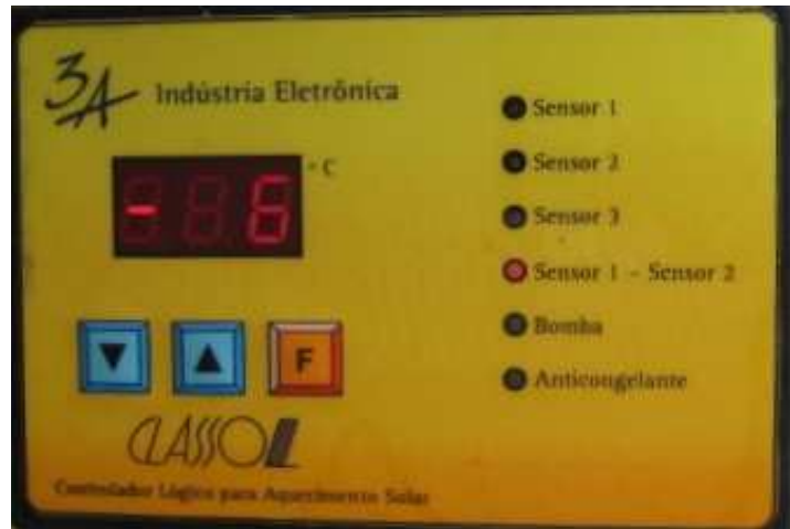
FIGURA 23– Controlador lógico para aquecimento solar
