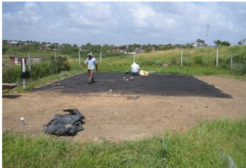
Figura 3.3 – Placa de concreto betuminoso usinado a quente (CBUQ).
