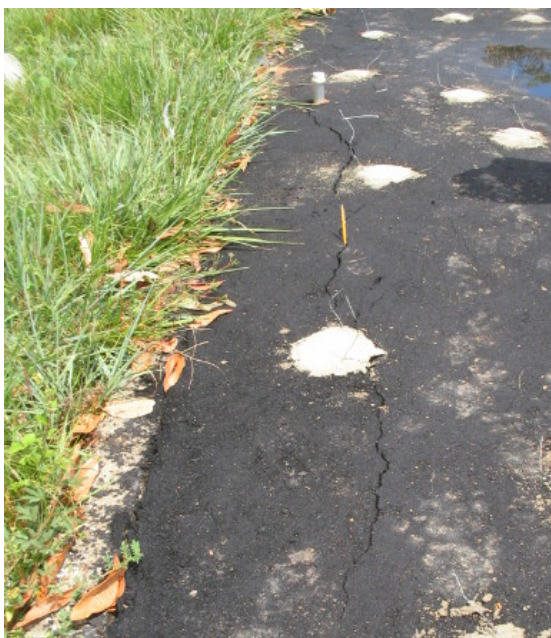
Figura 4.28 – Fissuras causadas no limite placa/área com vegetação pela retirada de umidade das raízes do solo.
