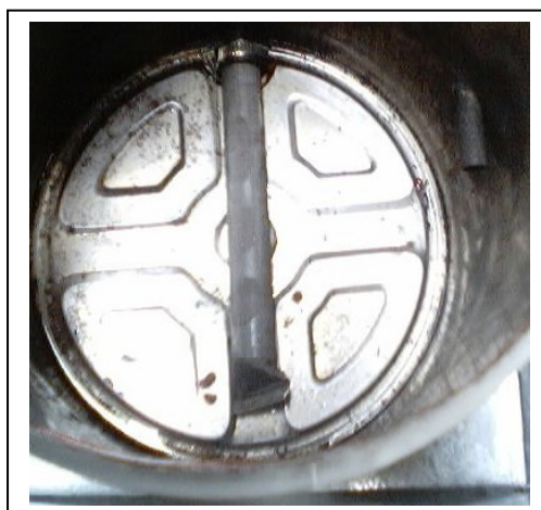
Figura 3.3.5 - Filtro e suporte fixados ao tanque para parafina fundida.
