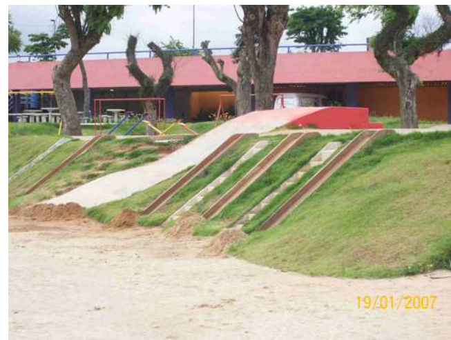
Escorrega de Talude
