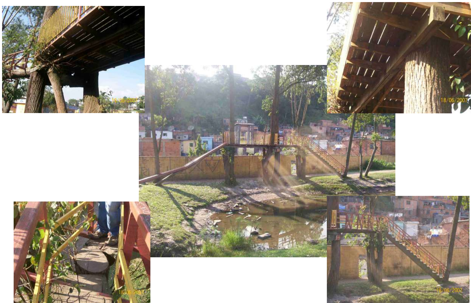
Fig.62 – Fotos - “Casa do Tarzan” – CESA- Cata Preta – Detalhes da escada, estrutura e passagem do brinquedo - 18/05/2007
