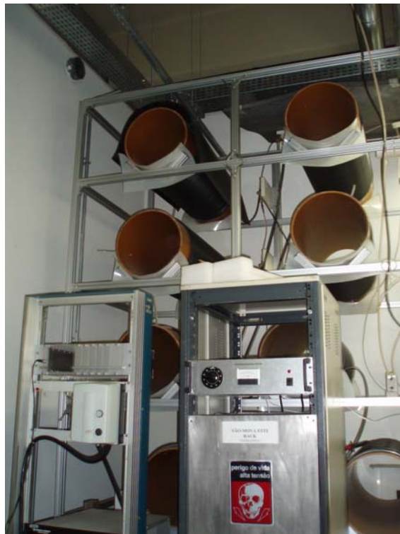
Fig. 4.8: Pulsador de alta tensão Stacked Blumlein.
