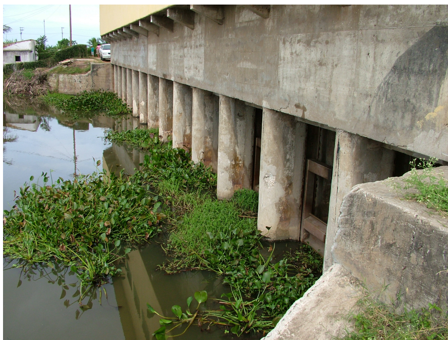
Figura 26 – Detalhe das comportas do canal São Bento.
