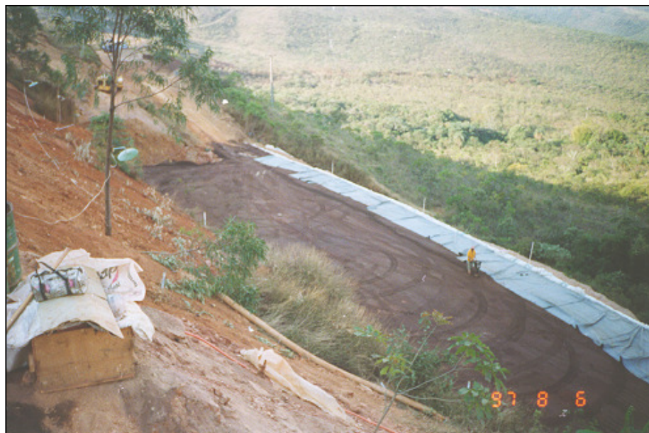
Figura 3.10b- Serviço de compactação de borda e detalhe das dobras feitas nas mantas.
