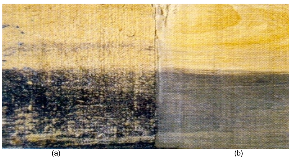
Figura 2.25 – Madeira atacada por fungos emboloradores: (a) aspecto macroscópico da superfície embolorada e (b) superfície aplainada (madeira aparentemente sadia, sem manchas). Fonte: IPT (2001)
