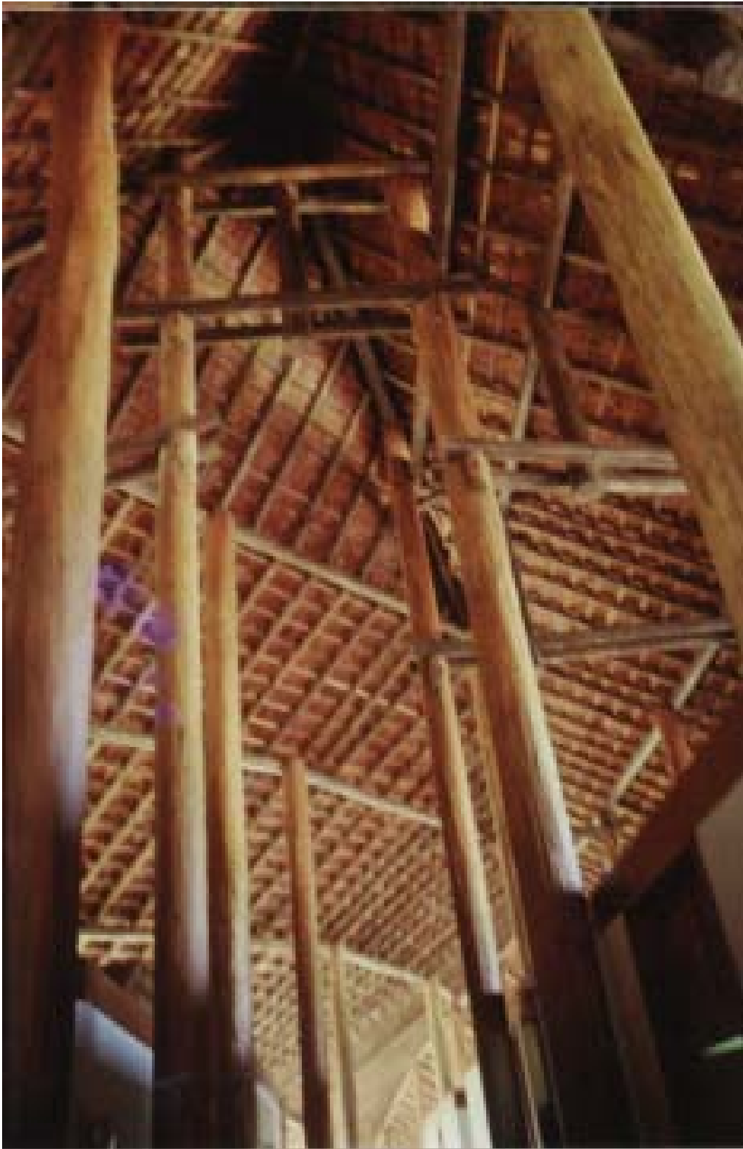
Figura 1.83 – CPA Balbina - Detalhe do encontro dos pilares com a estrutura do telhado Fonte: Arquivo Ruth Zein (2002)
