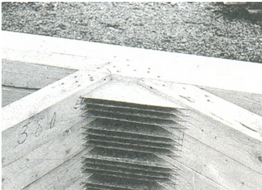
Figura 2.113 – Nó de vigamento triangular, com chapa metálica pregada embutida na madeira (sistema Greim ) Fonte: Natterer (1998)
