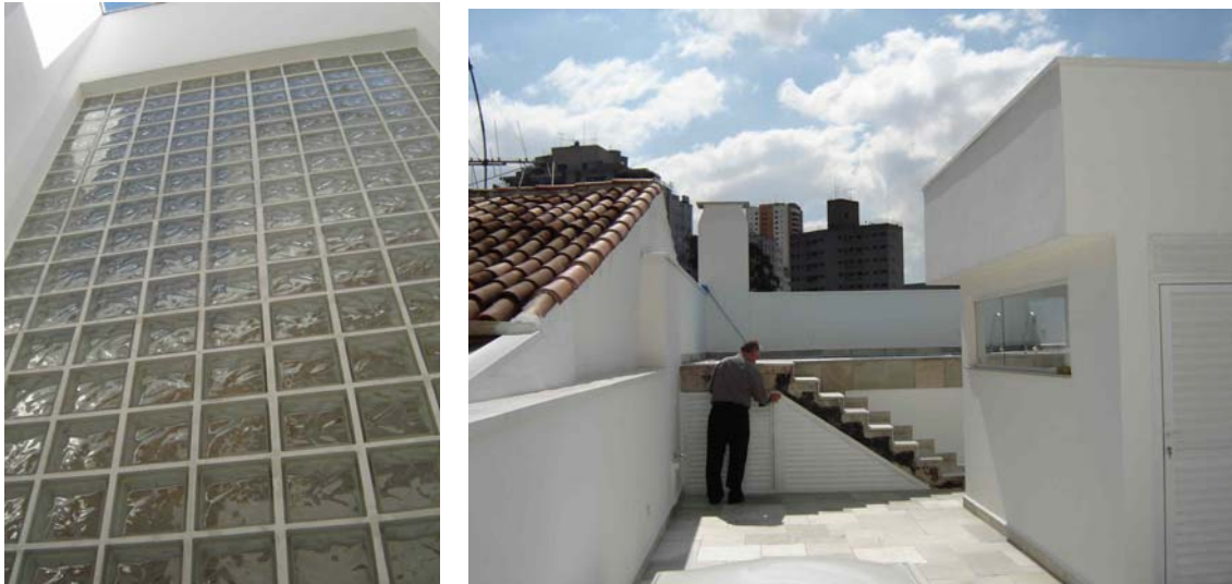
Figura 22 - Parede alta de tijolos de vidro (à esquerda) no duto das escadas e, ao fundo acesso à piscina pré-fabricada em vinil, bem como à direita dessa vista, o duto coberto das escadas (à direita) – Fonte: foto do próprio autor (maio de 2006)
