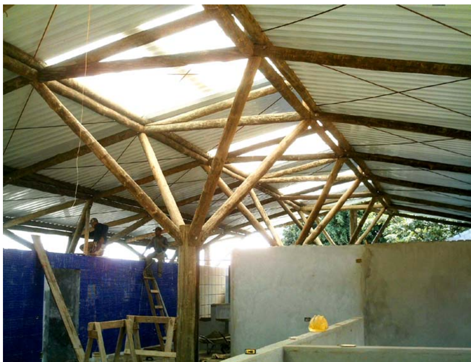
Figura 3. 105 – Obra: Creche Municipal – execução da firma CALLIA ESTRUTURAS DE MADEIRAS – autoria do Arquiteto André Takia. Fonte: foto da própria firma (2007)
