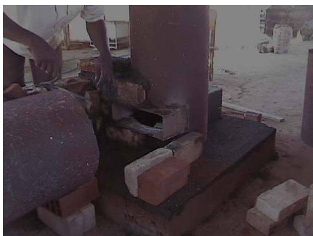
Figura 8: Abertura para saída dos gases do reator.
