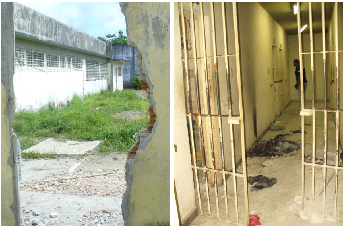
Foto 60 – Parede de ala destruída, grades arrombadas. (Mônica Gusmão)
