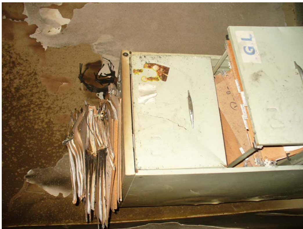
Foto 51 – Sala de atendimento técnico incendiada; prontuários dos adolescentes parcialmente destruídos. (Mônica Gusmão)
