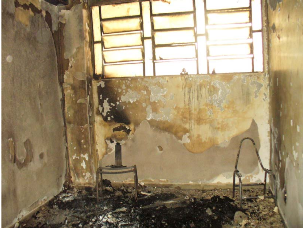
Foto 53 – Sala de atendimento técnico destruída. (Mônica Gusmão)
