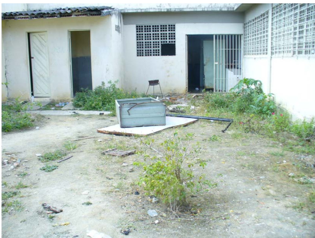
Foto 58 – Ala com parede e grades derrubadas. (Mônica Gusmão)
