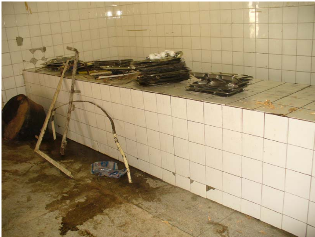
Foto 54 – Refeitório danificado. (Mônica Gusmão)
