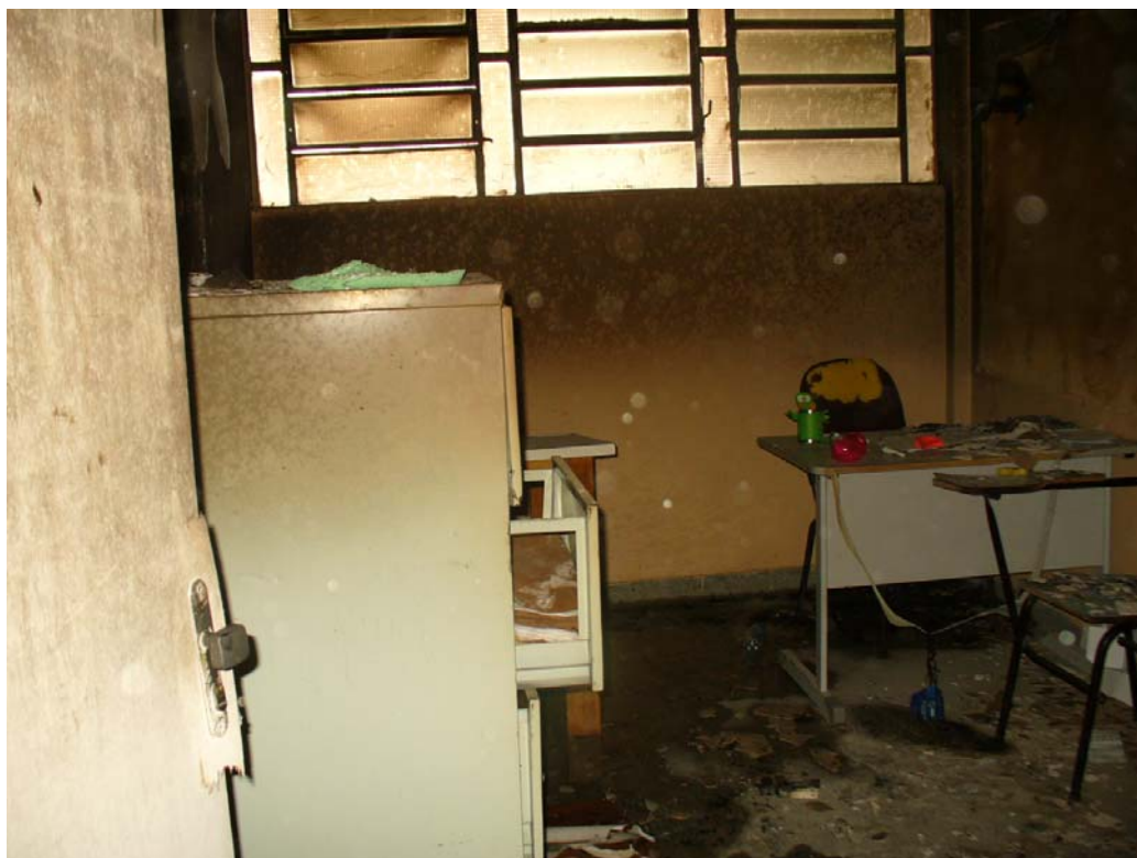
Foto 55 – Sala de atendimento técnico incendiada. (Mônica Gusmão)
