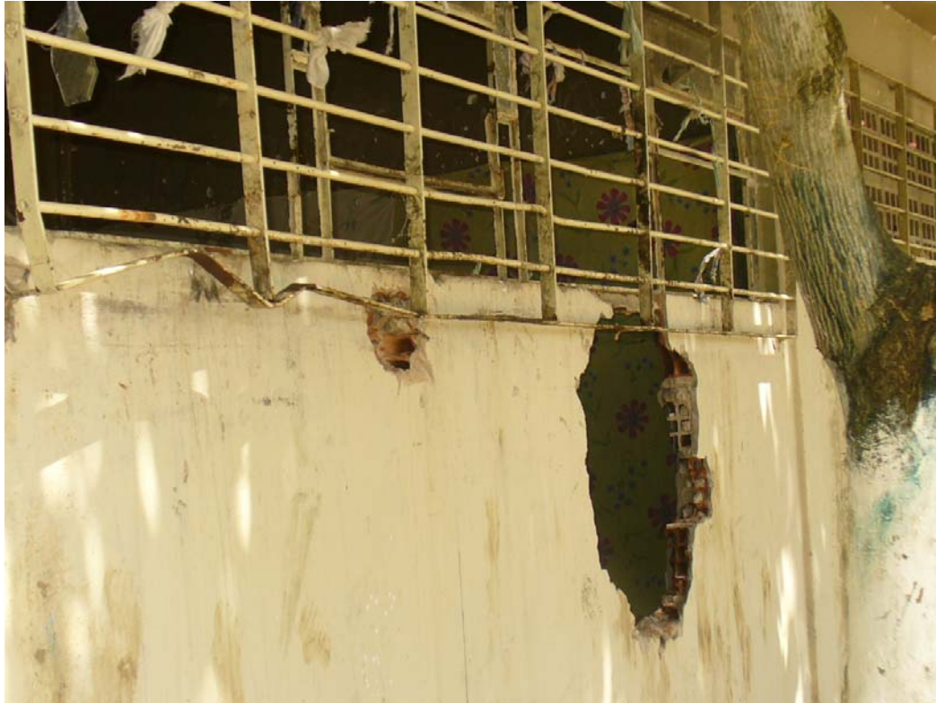
Foto 61 – Buraco feito na parede de uma ala da instituição. (Mônica Gusmão)
