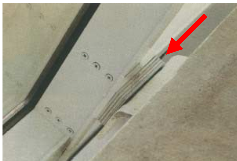
Figura 21 – Contato bi-metálico aço-alumínio – COSTA 21
