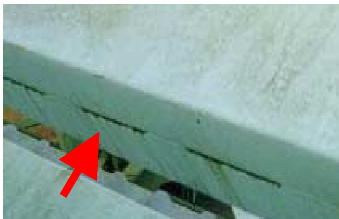
Figura 20 – Corrosão em frestas
