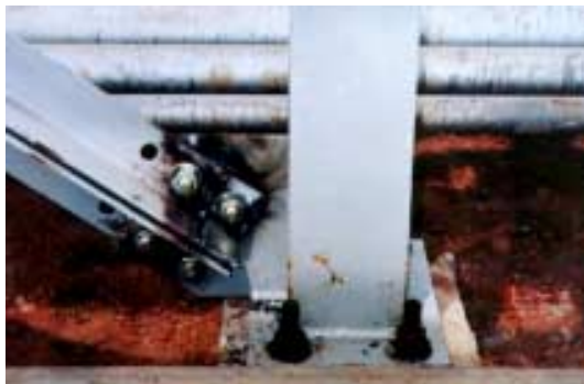
Figura 53 - Erro de projeto: comprimento insuficiente – BETINELI 12 , ZACARIAS 55
