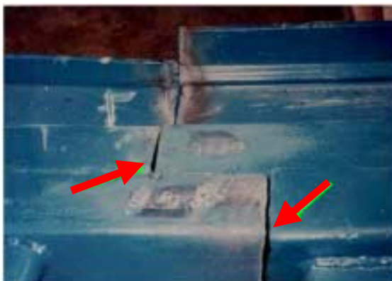
Figura 43 - Folgas na emenda devido a falta de concordância – BETINELI 12 , ZACARIAS 55
