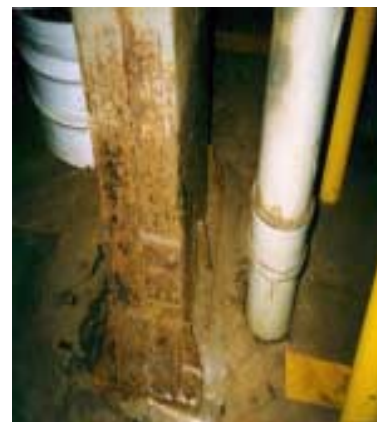
Figura 8 - Exemplo de corrosão uniforme em uma coluna metálica
