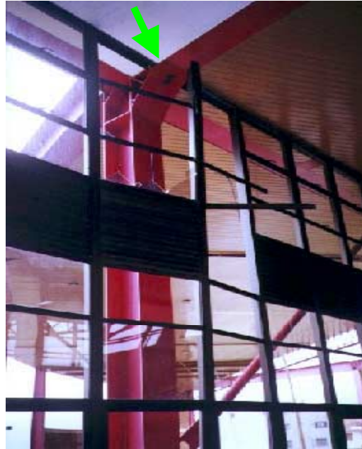
Figura 58 - Estrago causado pela pressão do vento
