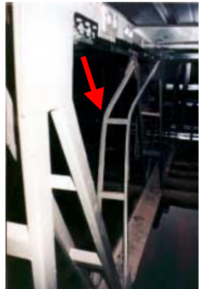
Figura 60 - Exemplo de falha por perda de estabilidade – BETINELI 12 , ZACARIAS 55
