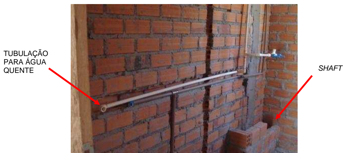
Figura 12: Tubulação para água quente
