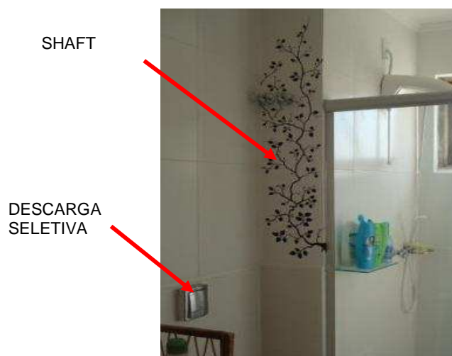
Figura 13: Shaft e descarga seletiva para economia de água
