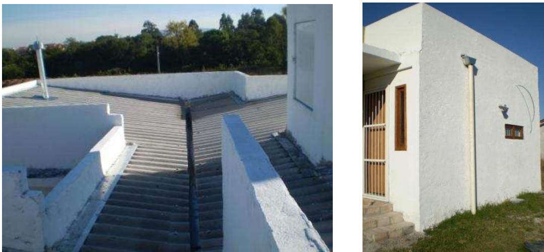
Figura 14 (a) e (b): Calha central para captação de águas pluviais
