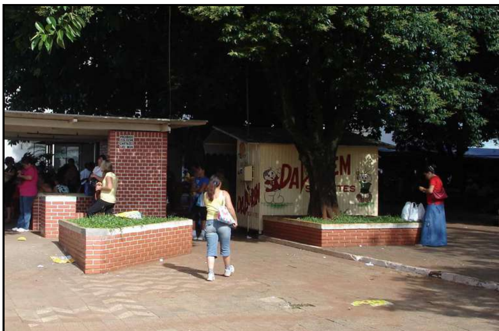
Figura 74 – Degrau no passeio interno da praça.
