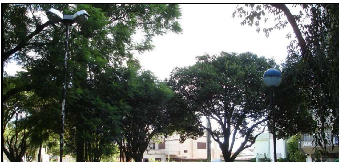
Figura 78 – Tipologia de luminária existente na praça.
