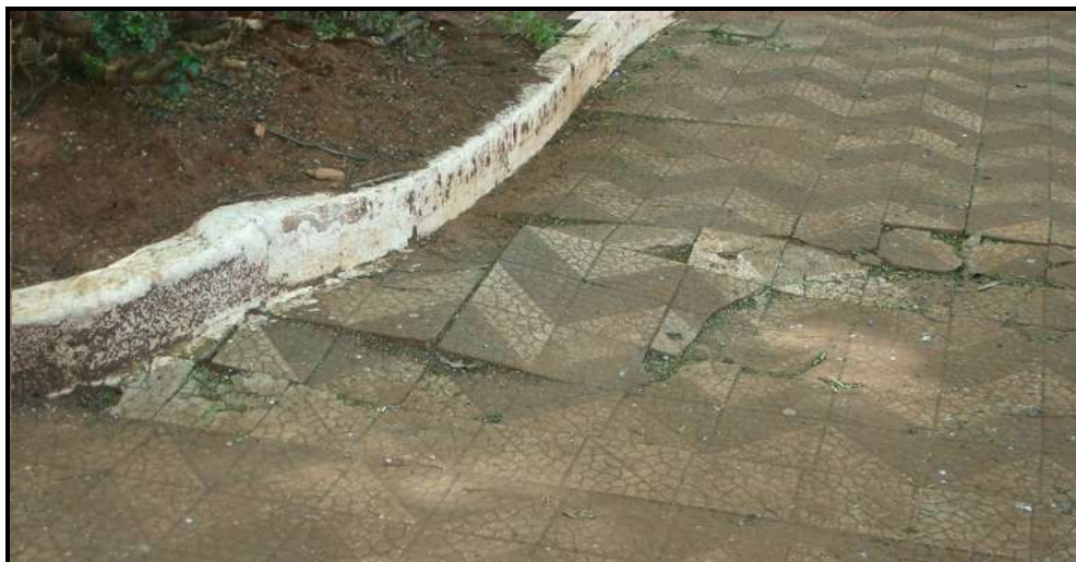
Figura 73 – Irregularidades no piso.
