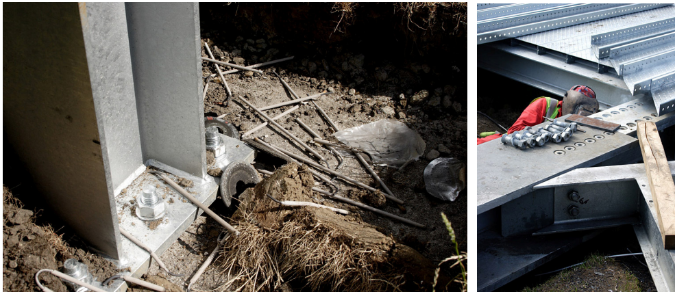
Detalhe do pilar metálico parafusado na sapata. Ao lado, encaixe das vigas de baldrame também presas com parafusos e sem solda. Fonte: http://wemadethis.typepad.com/photos/uncategorized
