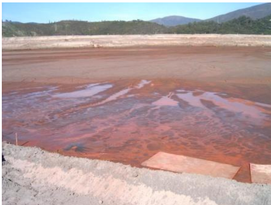
Figura 5.2 – Detalhe da magnitude das surgências de água percebidas durante a construção do forro do aterro teste
