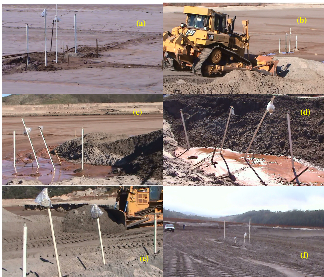
Figura 4.24 – Condição das placas de recalque (hastes extremas) em diversos momentos da construção do aterro, em ordem cronológica na sequência de (a) para (f)
