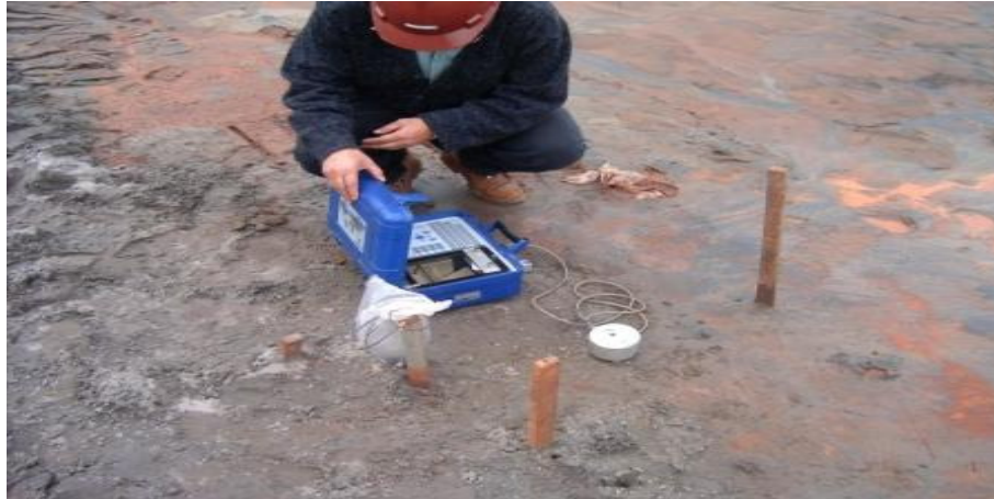
Figura 4.41 – Detalhe do aparelho de medição de vibração
