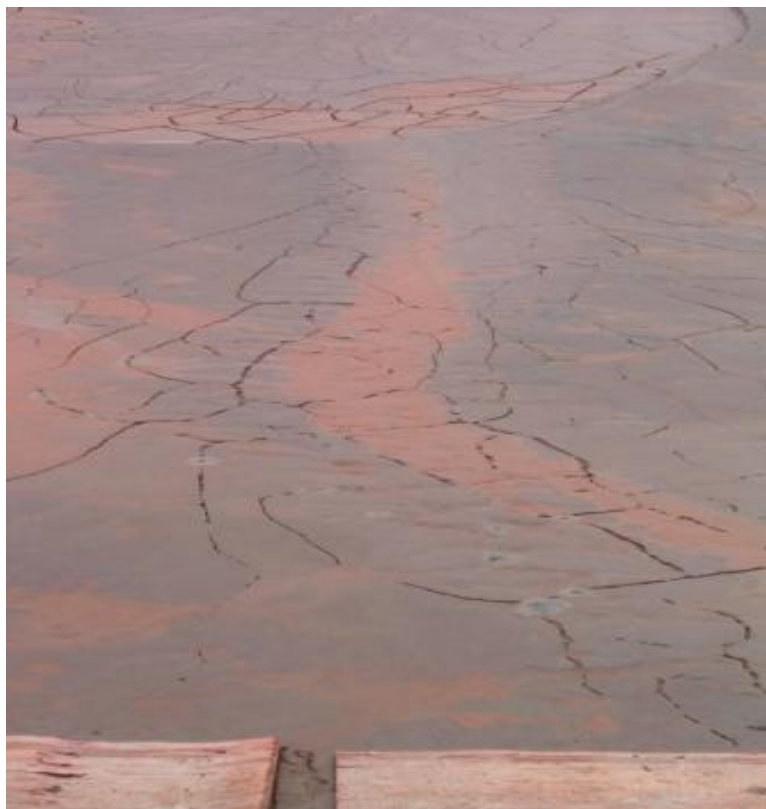
Figura 4.38 – Trincas de alívio de poropressão
