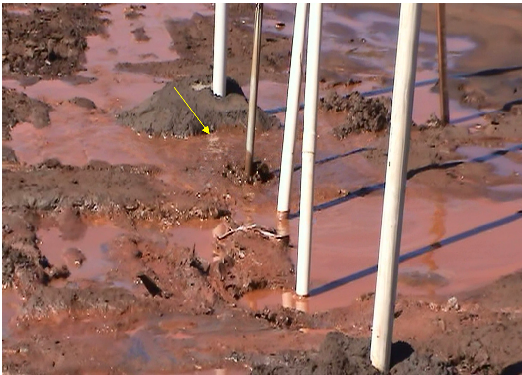
Figura 4.18 – Evento de artesianismo junto ao Lev3, no segundo dia da construção do forro
