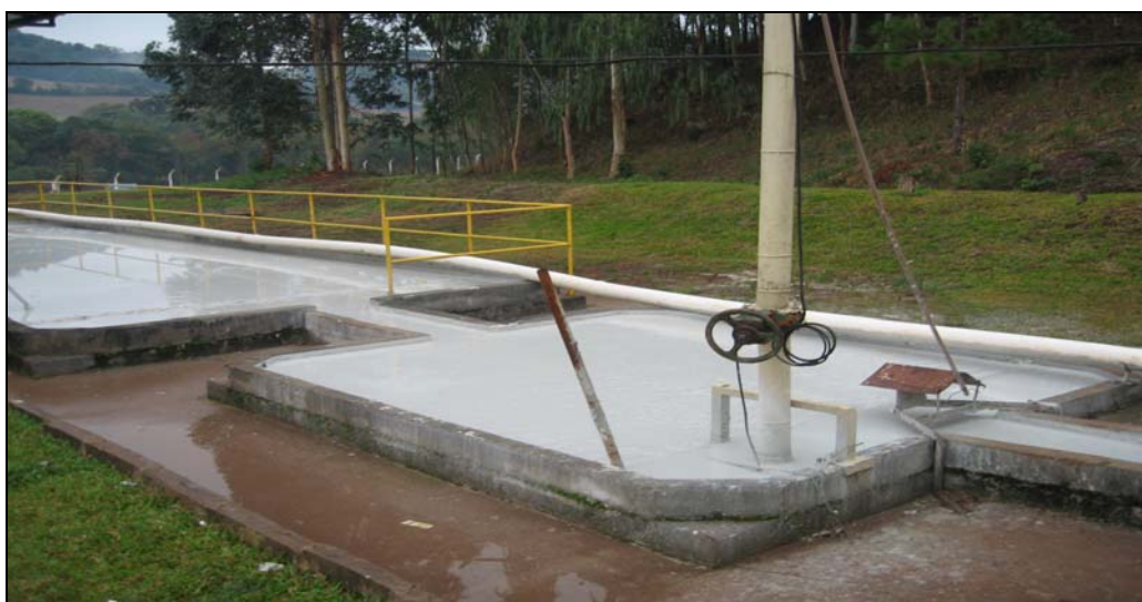
Figura 32 - Estação de tratamento de água
