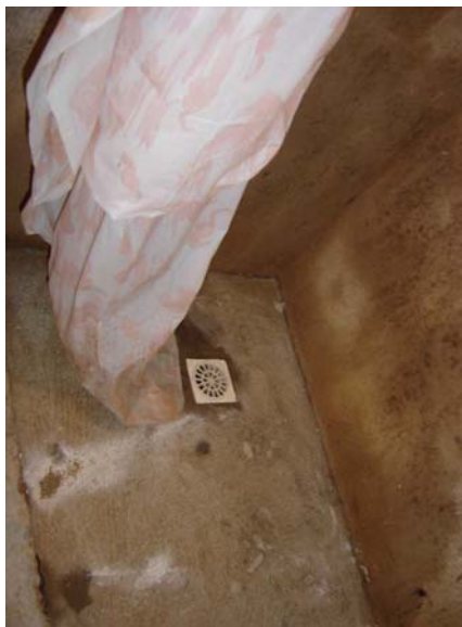
Figura 88 – Aspecto das caixas sifonadas encontradas no conjunto habitacional Donária
