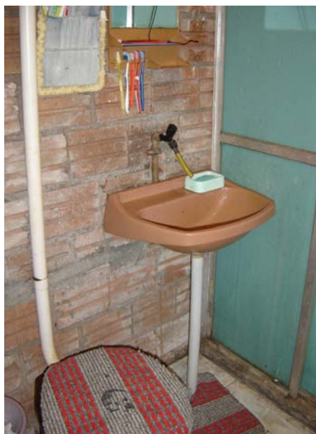
Figura 44 – Torneira do lavatório inadequada no conjunto habitacional José Alexandre Zacchia
