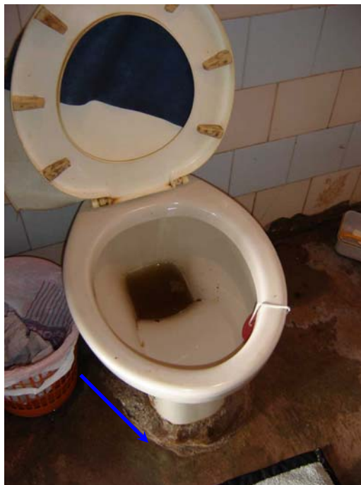
Figura 65 – Bacia sanitária com excesso fixação na base no conjunto habitacional Jaboticabal/Alvorada
