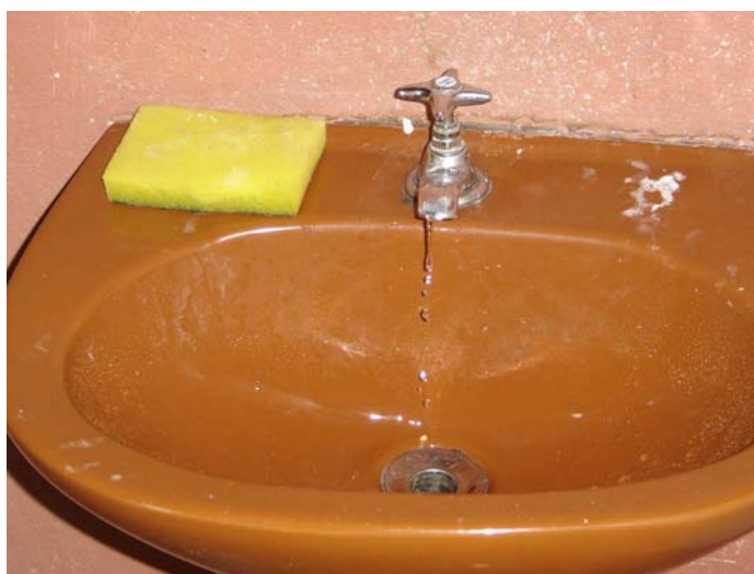
Figura 46 – Torneira do lavatório com gotejamento médio no conjunto habitacional José Alexandre Zacchia
