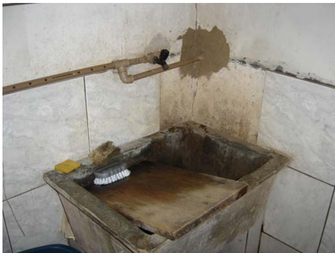
Figura 49 – Torneira incompatível e com altura inadequada para uso no conjunto habitacional José Alexandre Zacchia
