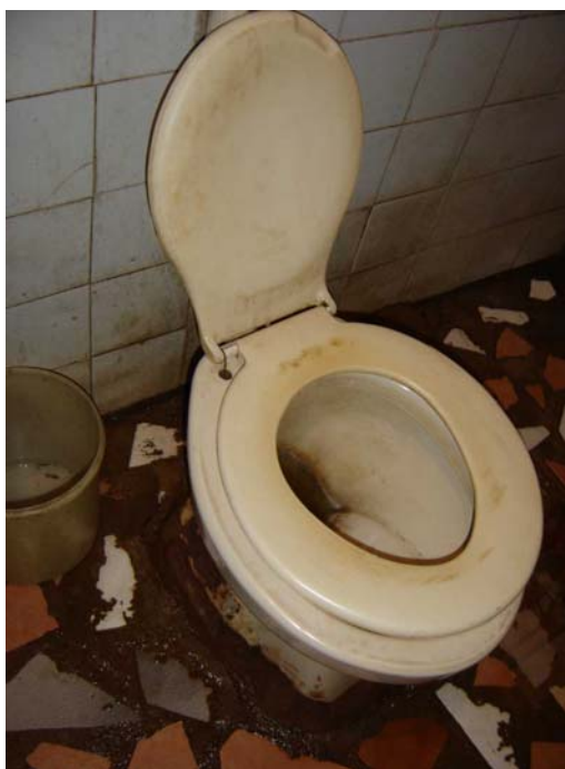
Figura 64 – Bacia sanitária manchada encontrada no conjunto habitacional Jaboticabal/Alvorada
