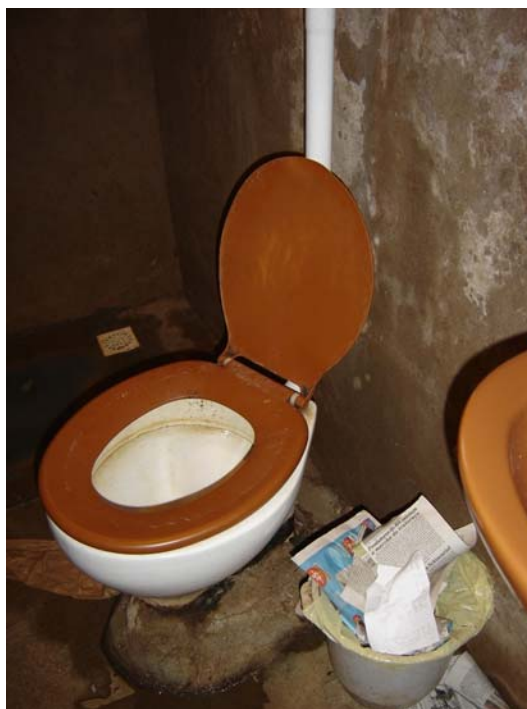
Figura 80 – Bacia sanitária fora de prumo e com excesso de cimento na vedação encontrada no conjunto habitacional Donária
