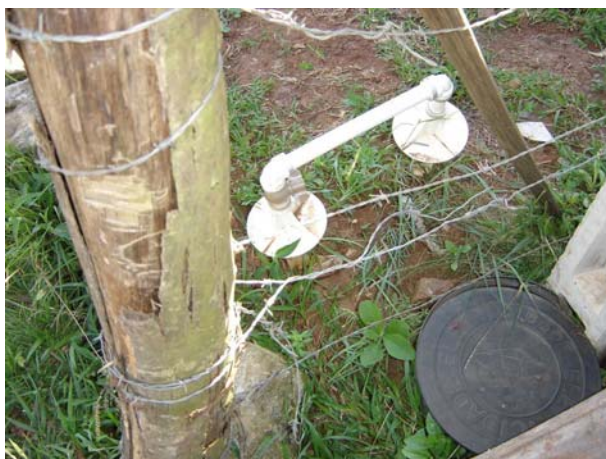
Figura 78 – Cavalete de hidrômetro no conjunto habitacional Jaboticabal
