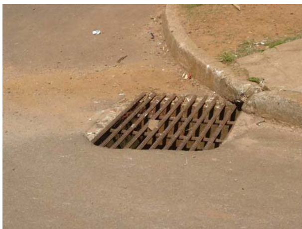
Figura 77 – Boca de lobo no conjunto habitacional Manoel Corralo
