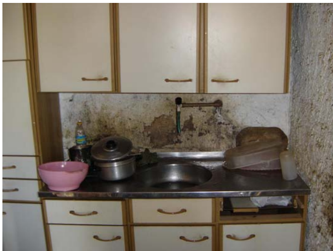
Figura 50 – Torneira da pia de cozinha incompatível com o uso no conjunto habitacional José Alexandre Zacchia
