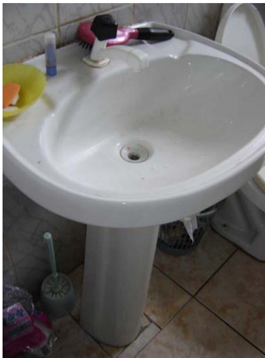
Figura 66 – Torneira do lavatório adequada encontrada no conjunto habitacional Manoel Corralo
