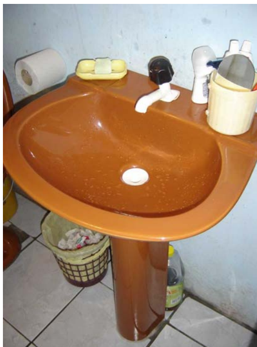
Figura 81 – Torneira lavatório adequada encontrada no conjunto habitacional Donária
