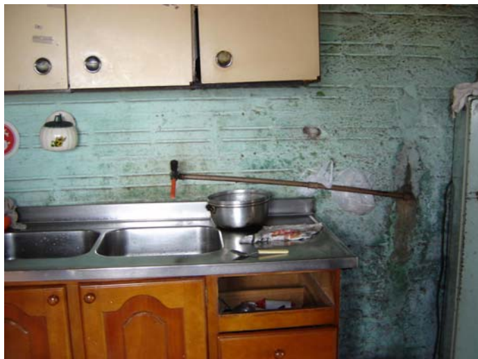
Figura 52 – Torneira da pia de cozinha com as adaptações realizadas pelo usuário conjunto habitacional José Alexandre Zacchia
