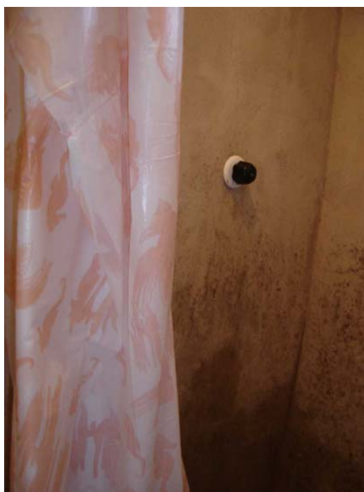
Figura 82 – Parede manchada e registro do chuveiro com vazamento no eixo quando aberto – conjunto habitacional Santa Marta PSH
