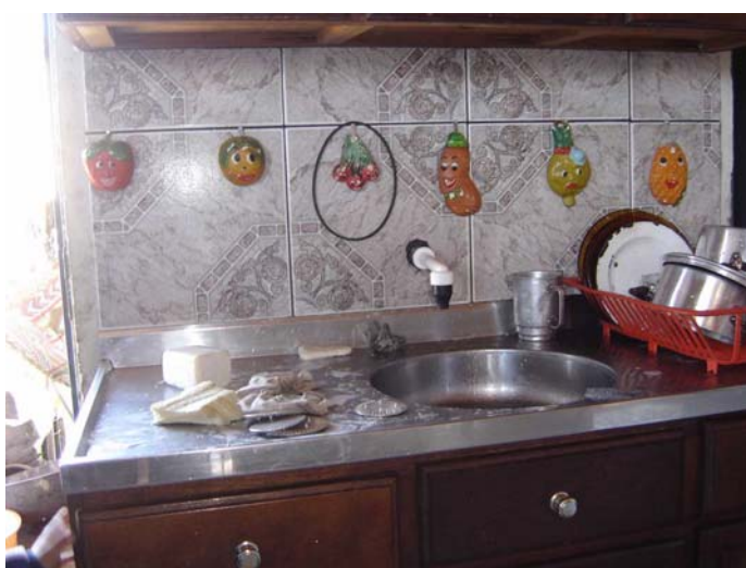
Figura 51 – Torneira da pia de cozinha adequada para o uso conjunto habitacional José Alexandre Zacchia
