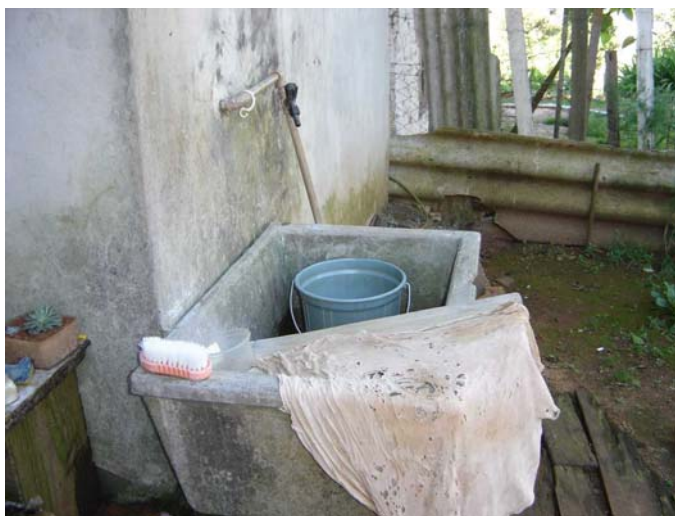
Figura 48 – Torneira do tanque incompatível e com altura inadequada para uso encontrada no conjunto habitacional José Alexandre Zacchia
