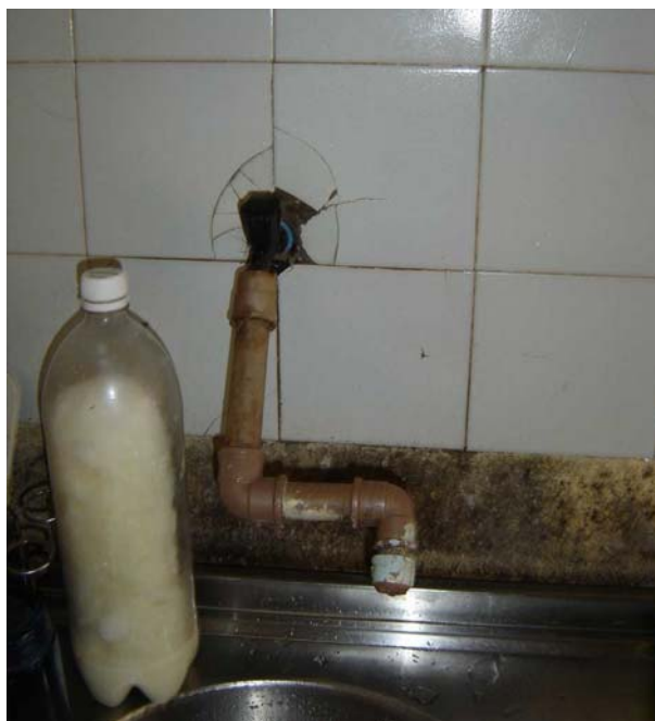
Figura 69 – Torneira incompatível na pia de cozinha no conjunto habitacional Jaboticabal/Alvorada
