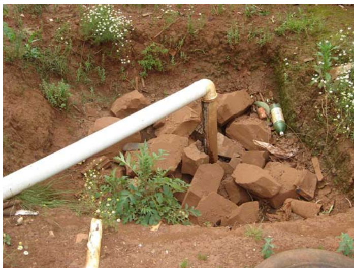
Figura 75 – Sumidouro inacabado no conjunto habitacional Jaboticabal/Alvorada
