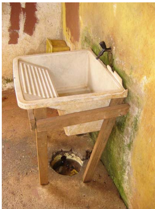
Figura 68 – Torneira inadequada para o tanque encontrada no conjunto habitacional Jaboticabal/Alvorada
