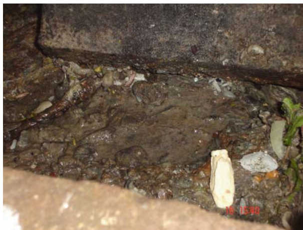
Figura 57 – Caixa de inspeção sem tampa no conjunto habitacional José Alexandre Zacchia
