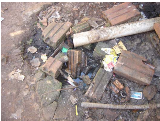
Figura 58 – Aspecto de uma caixa de inspeção encontrada no conjunto habitacional José Alexandre Zacchia
