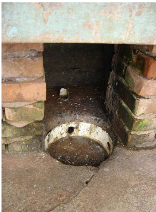
Figura 72 – Caixa de gordura com lodo e lixo no interior, e sem sifão encontrada no Jaboticabal/Alvorada
