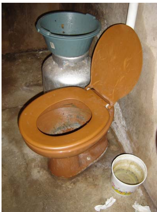
Figura 79 – Estado de conservação da bacia sanitária no conjunto habitacional Donária
