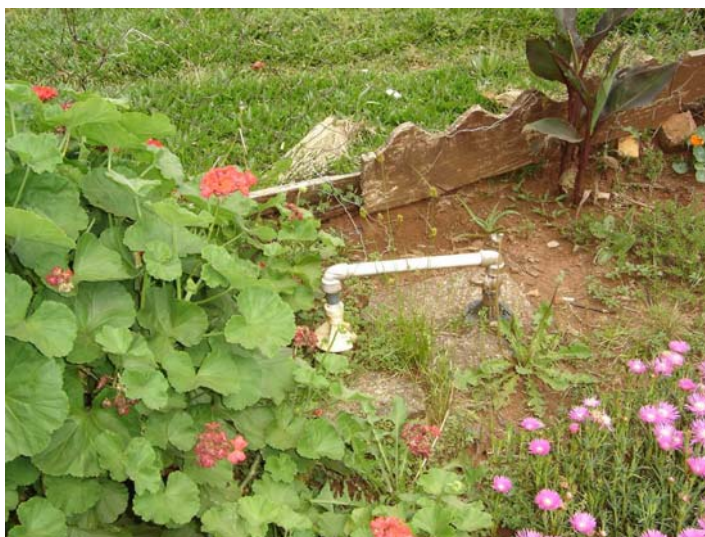
Figura 62 – Cavalete para o hidrômetro no conjunto habitacional Jaboticabal/Alvorada.
