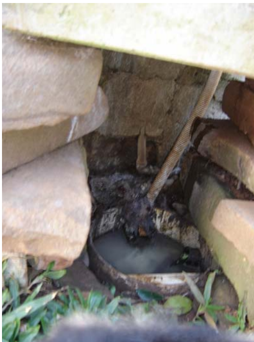
Figura 55 – Caixa de gordura sem tampa, com lodo e lixo no seu interior encontrada no conjunto habitacional José Alexandre Zacchia
