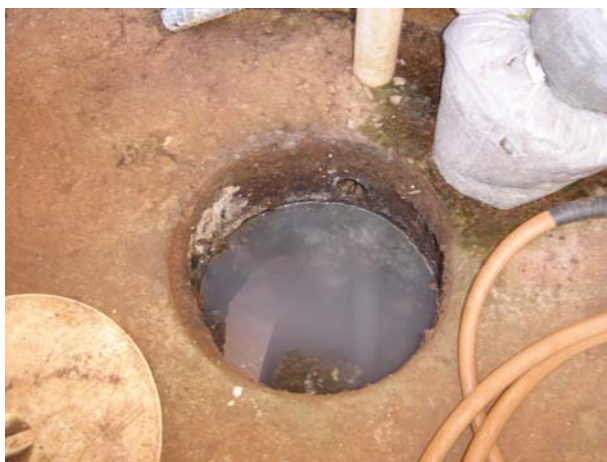
Figura 85: Caixa de gordura com lixo e sem sifão encontradas no conjunto habitacional Donária
