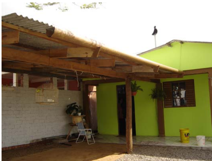
Figura 60 – Calha de PVC no conjunto habitacional José Alexandre Zacchia
