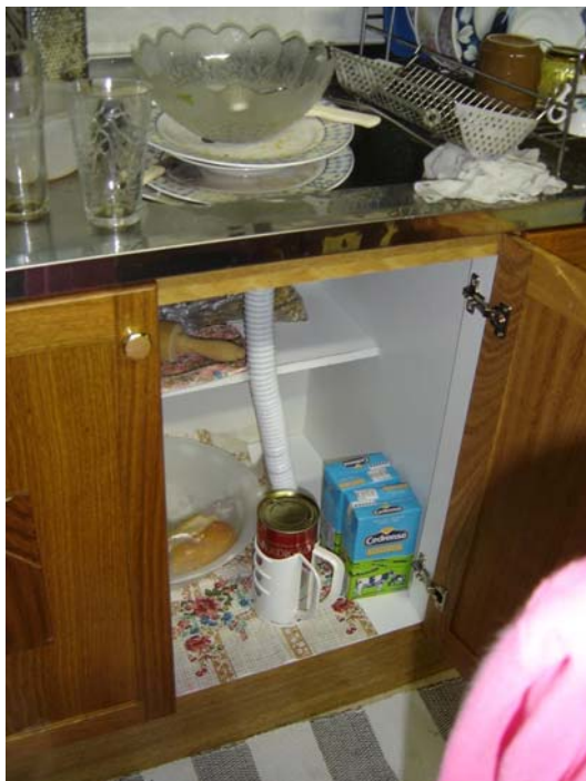
Figura 53 – Ramal de descarga da pia de cozinha com sifão do tipo flexível no conjunto habitacional Lucas Araujo
