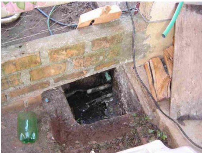
Figura 89: Caixa de inspeção com acúmulo de lixo no interior encontrado no conjunto habitacional Donária
