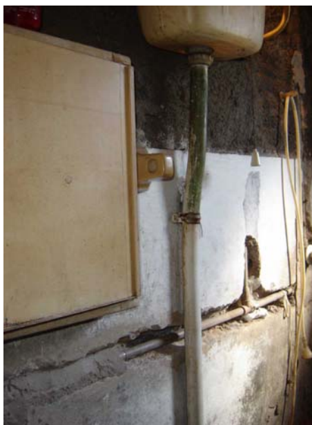
Figura 47 – Sub-ramal de alimentação do chuveiro visível no conjunto habitacional José Alexandre Zacchia
