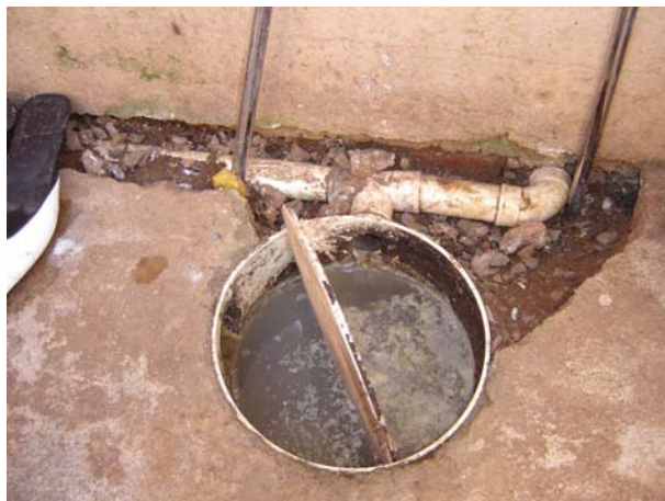
Figura 86: Caixa de gordura com lixo, lodo e sem sifão encontrada no conjunto habitacional Donária
