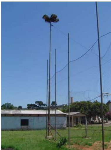
Figura 135 – Luminária alta existente no centro da praça
