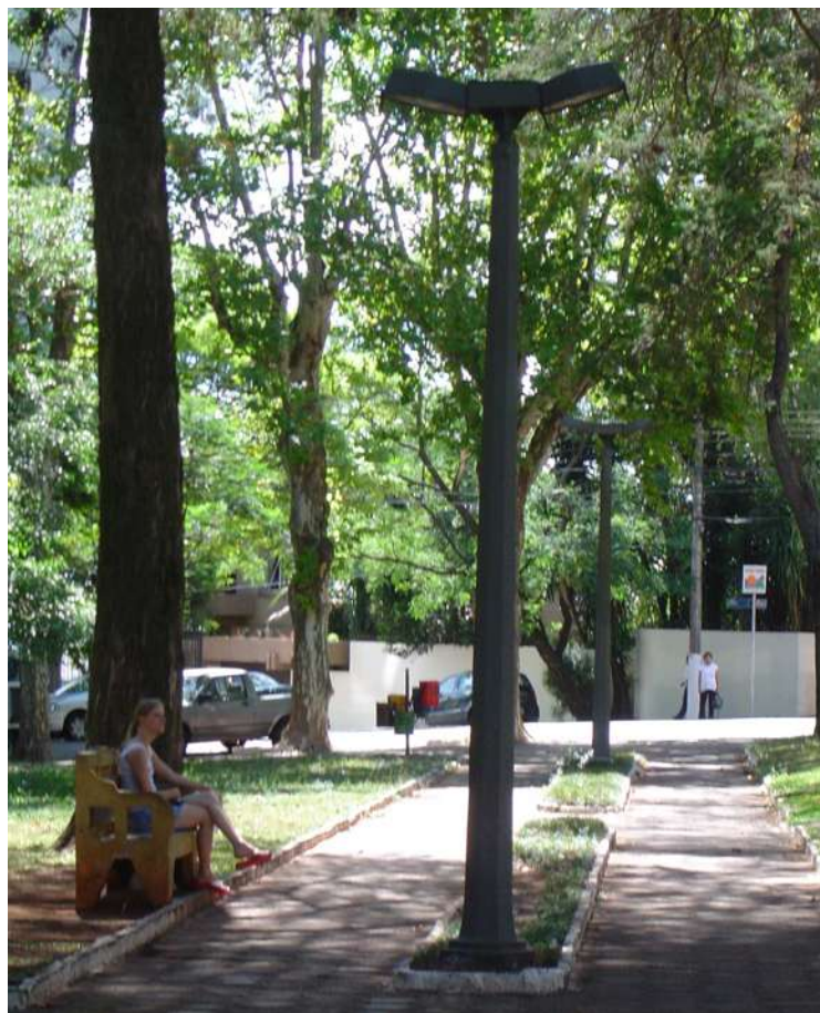
Figura 70 – Tipo de luminária existente na Praça Tamandaré
