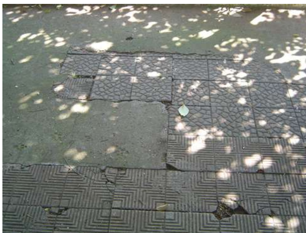
Figura 98 – Piso em diversos padrões com aspecto de “remendo”
