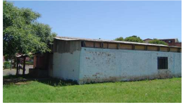
Figura 128 – Vista do galpão com baixa qualidade de padrão construtivo
