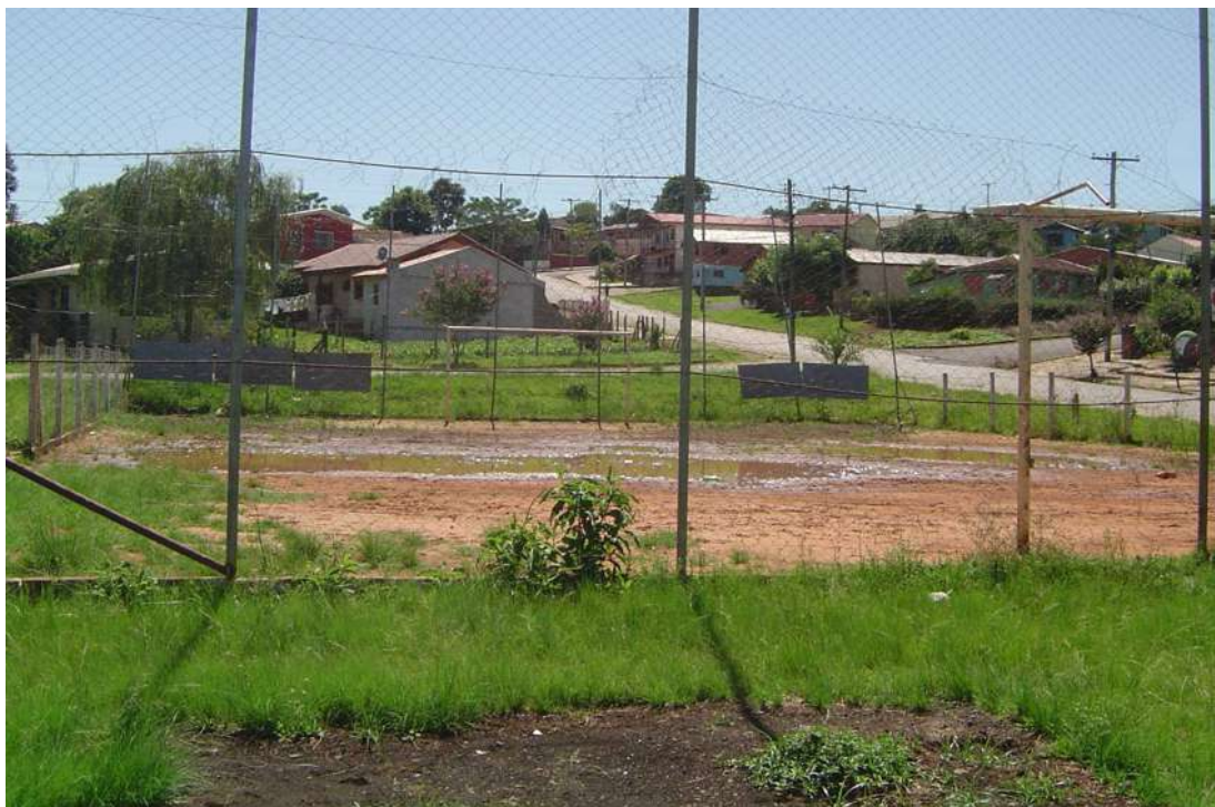
Figura 139 – Quadra de areia sem condições de uso por causa da água da chuva empossada
